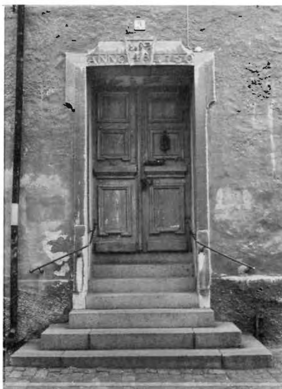
Figur 39. Portal av öländsk kalksten från 1750, kvarteret Landshövdingen 17 i Kalmar. Huset är från omkring 1660 men portalen tillkom vid ägarbyte. Portalen konserverades 1992 och fasaden renoverades 1995. Foto Ö. Molander 1990, Länsstyrelsen i Kalmar.
