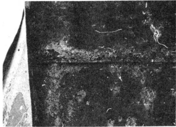
Korrosionsskada orsakad av att kondensvatten på plåtens undersida runnit in i hakfalsen. Enköpings-Näs kyrka. Foto 1976.
