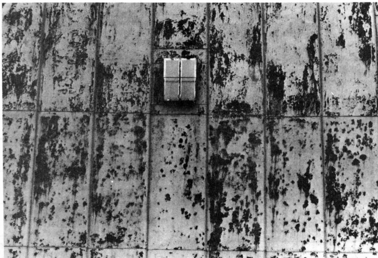
Tak med korrosionsangrepp orsakade av eftersatt underhåll. Södermalm, Stockholm. Foto 1980.
