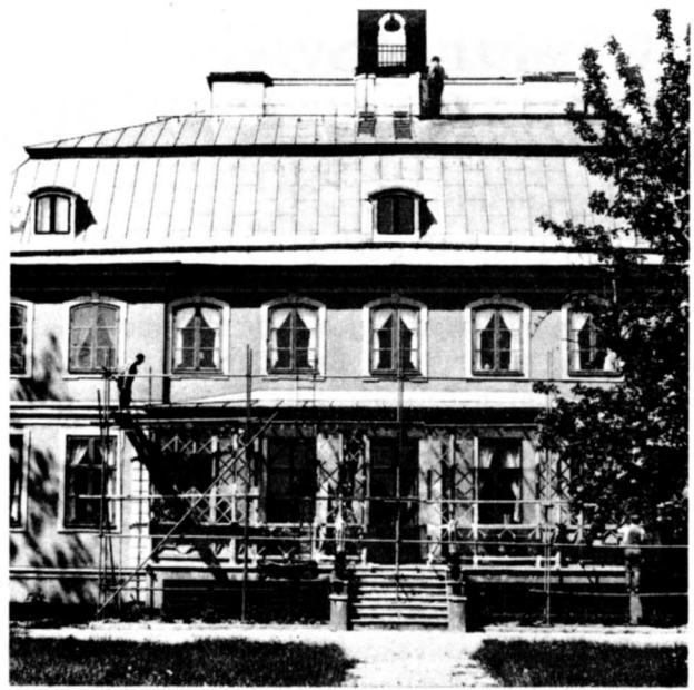
Dokumentationsfoto av Kristinebergs slott, efter omläggning av taket, men före målning. Foto 1979.
