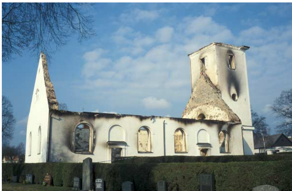
Ryssby kyrka efter branden våren 2001. Församlingen har diskuterat alternativa lösningar till en återuppbyggnad. Den allmänna viljan är dock att kyrkan ska återuppföras och arbetet med återuppbyggnaden har påbörjats. Kyrkans exteriör kommer att återställas. Foto: Kerstin Alexandersson.
