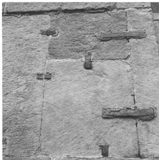
83. Hakkramlor (och svanskramlor?) av järn för fästning av beklädnadsstenar av sandsten på sockel. Bakmur av tegel. 1600-tal. Katarina kyrka, Stockholm. Foto K Andersson 1976
