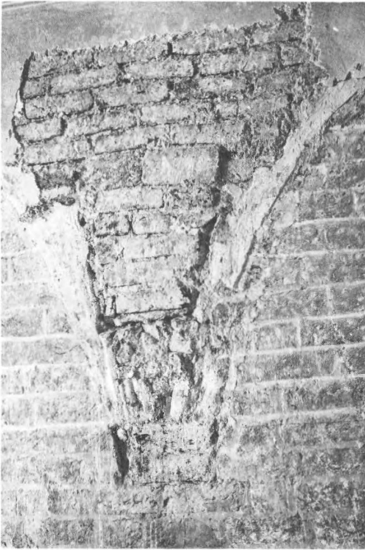
107. Spår av kryssvalv. Upplaget igenmurat efter rivningen av valvet. 1300-tal. Vapenhuset, Ångsö kyrka, Västmanland. Foto M Bratt-Gustafsson 1971
