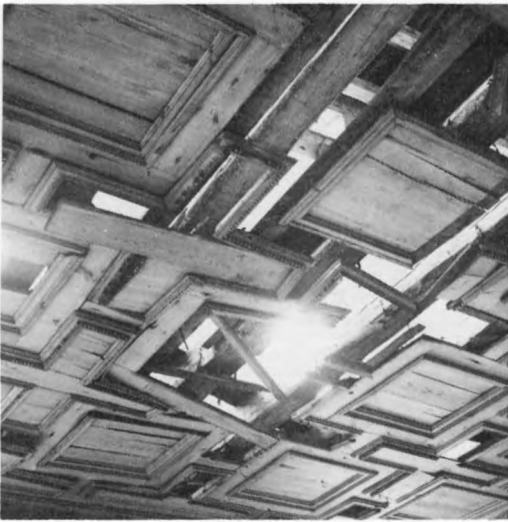
148. Kassettak. Ramverket är hängslat med järn i bjälkarna och fyllningarna vilar i ramverken. Omkring 1600. Tynnelsö hus, Södermanland. Foto ATA P O Westlund 1941
