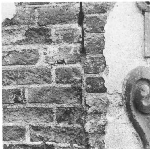
105. Skarv mellan två olika medeltida murverk. Det vänstra är äldst. Murverket har ungefär upp till bildens mitt ett anlagt murhörn med omväxlande löp och kopp. Däröver har funnits en senare avhuggen förtagning. (Man har ofta måst hugga bort sådana utskjutande förtagningar, då det nya murverkets skiftgångar lätt kom i otakt med det äldres.) 1300-tal. Gamla stenhuset, Skokloster, Uppland. Foto K Andersson 1973
