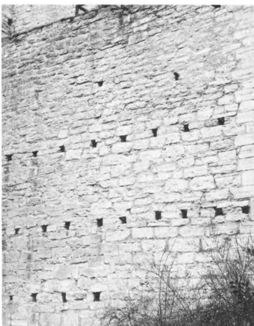
6. Murverk av kalksten med kvaderhuggen hörnedja. (Bomhålen från byggnadsställningar.) 1200-tal. S:t Clemens kyrkoruin, Visby, Gotland. Foto A Hildebrand 1976
