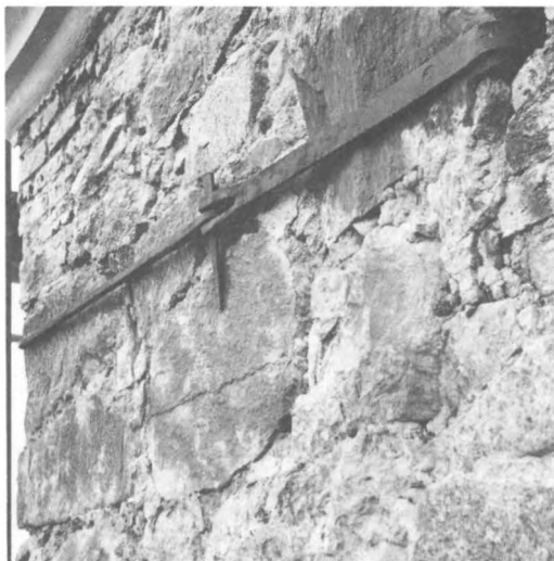
84. Järnband runt hörn med sättningsprickor; Restaureringsåtgärd. Odensala kyrka, Uppland. Foto A Hildebrand
