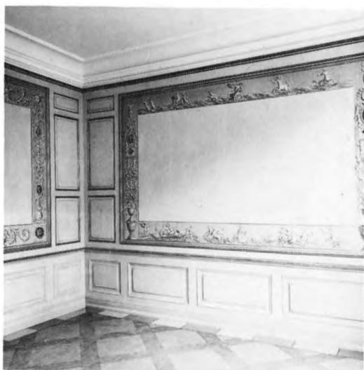
143. Målad imitation av ekparkett och stenfris på enkelt furugolv. Förmaket, Skogsholms herrgård, Skansen.
