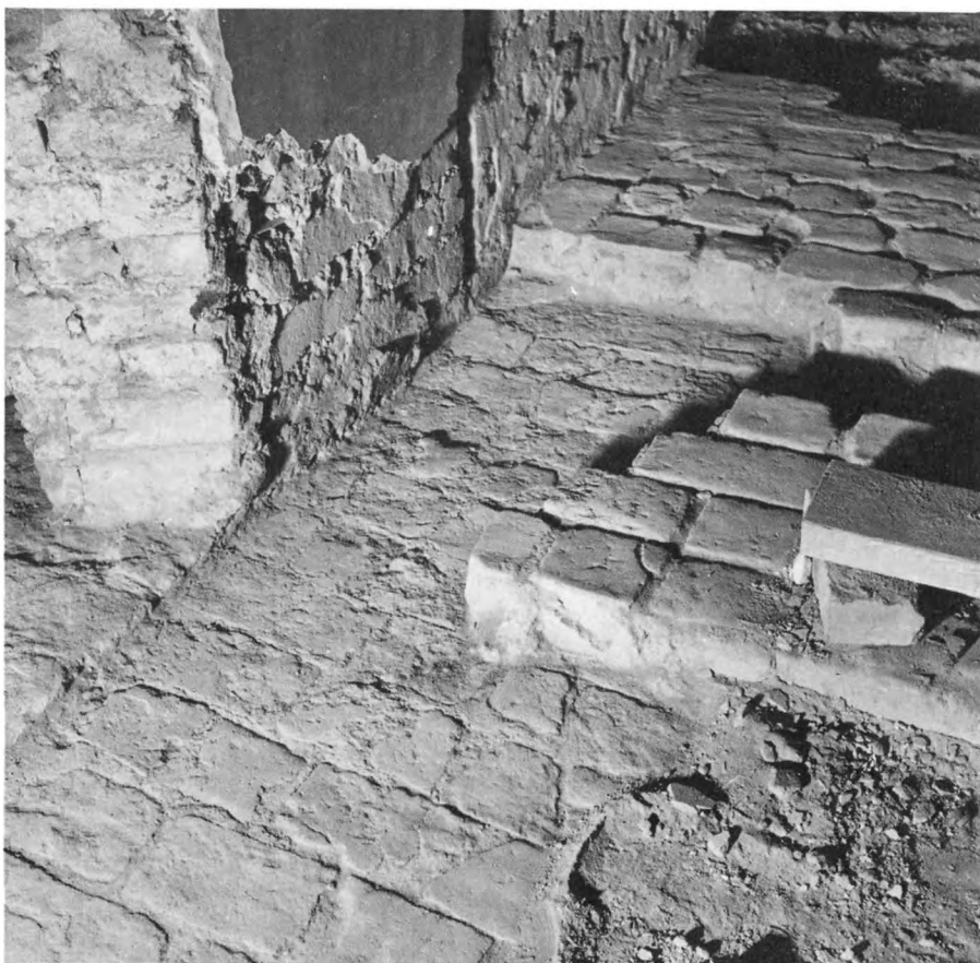
144. Två lager av tegelgolv. Det undre ca 1400 (klostertid). Det övre från 1600-talet. Norra längan, dormitoriet, Vadstena gård och kloster, Östergötland. Foto I Anderson
