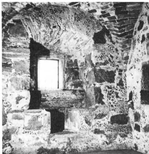
46. Gråstensmurverk med brett utstrukna fogar och "skolning" med tegelflis. Tegelflisen har fungerat som torkmedel för bruket. Omkr 1500. Glimmingehus, Skåne. Foto I Anderson
