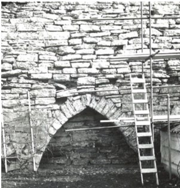
Figur 2.5: Fotografi taget 1964 under restaurering av insidan av mur 26 vid Norra Murgatan. Bilden beskriver ganska väl den generella statusen för stora partier av muren. Man förstår genom jämförelse med murpartiets utseende idag att det tillförts en hel del ny sten i muren och att fogarna med KC-bruk kunde bli ganska djupa, då den kunde vara eroderad upp till en halvmeters djup. Foto: Gotlands Museums arkiv.
