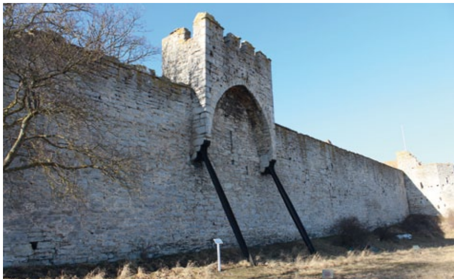
Figur 4.14. Stöttor av gjutjärn på sadeltornet på mur 36. Foto: Carl Thelin.
