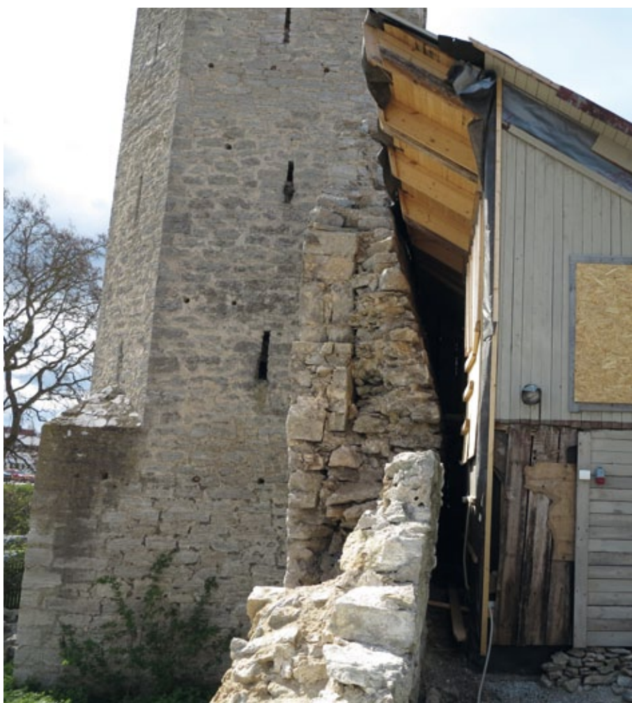
Figur 3.12. Profilen av den övre delen av den nedbrutna muren i söder. Den raka och jämna muren till vänster visar bröstvärdet med skytteöppning. Dess nedre avslut visar läget för en tillhörande skyttegång, vilket dock inte avtecknar sig som något tydligt skilje mellan den påbyggda muren och den äldre kärnan med inre skalmur. Den övre delen av kärnan låg inte i lerbruk. Överhuvud taget är det svårt att urskilja något skifte i stadsmurens inre skalmur mellan den äldre muren och den senare påbyggnaden. Foto: Håkan Thorén.
