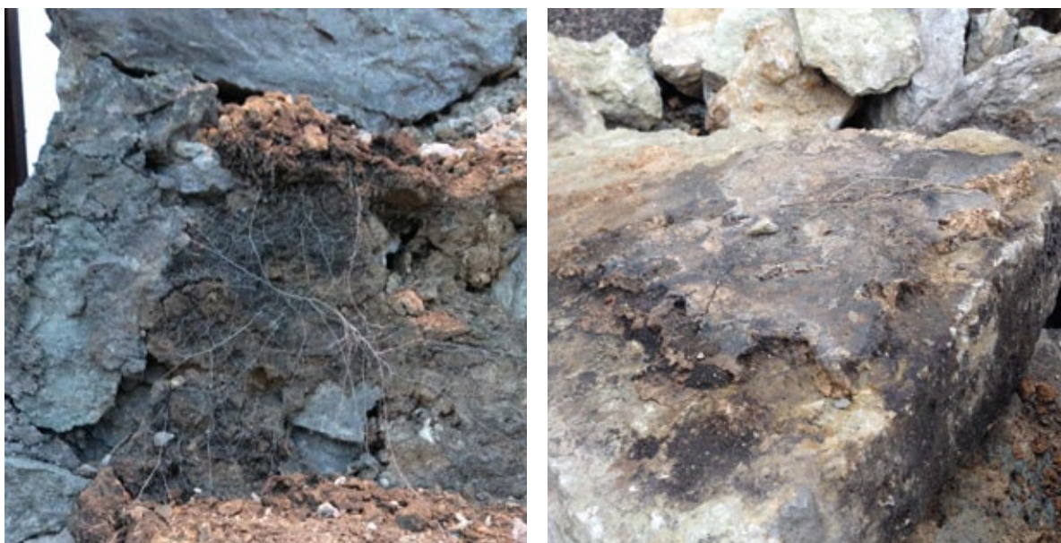
Figur 6.1. Växtlighet utanpå och i muren. Rötterna har trängt långt in i muren även om växten är till synes liten på ytan.
