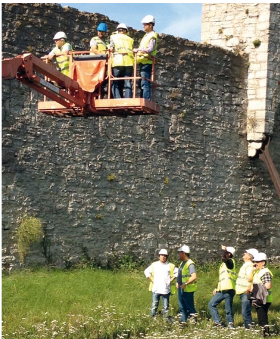
Figur 1.14. I samband med kunskapsseminariet i augusti 2012 fick deltagarna tillfälle att inspektera raset från skylift. Foto: Ulrika Mebus.
