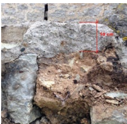
Figur 5.4. Under cementkrönet syns samma typ av inhomogent och fett kalkbruk som förekommer i hela den påbyggda muren. I den övre halvmeteren är det dock påverkat av fuktbelastningen. Det håller ännu ihop men det har mist sin seghet och vill gärna smula sig. Foto: Kristin Balksten.
