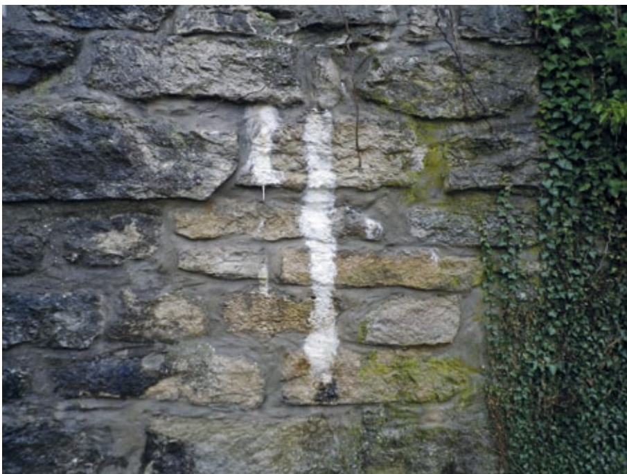
Figur 6.6. Cementbruket syns här påverka muren på olika sätt, genom vatteninträngning, urlakning och växtetablering. Foto: Kristin Balksten.
