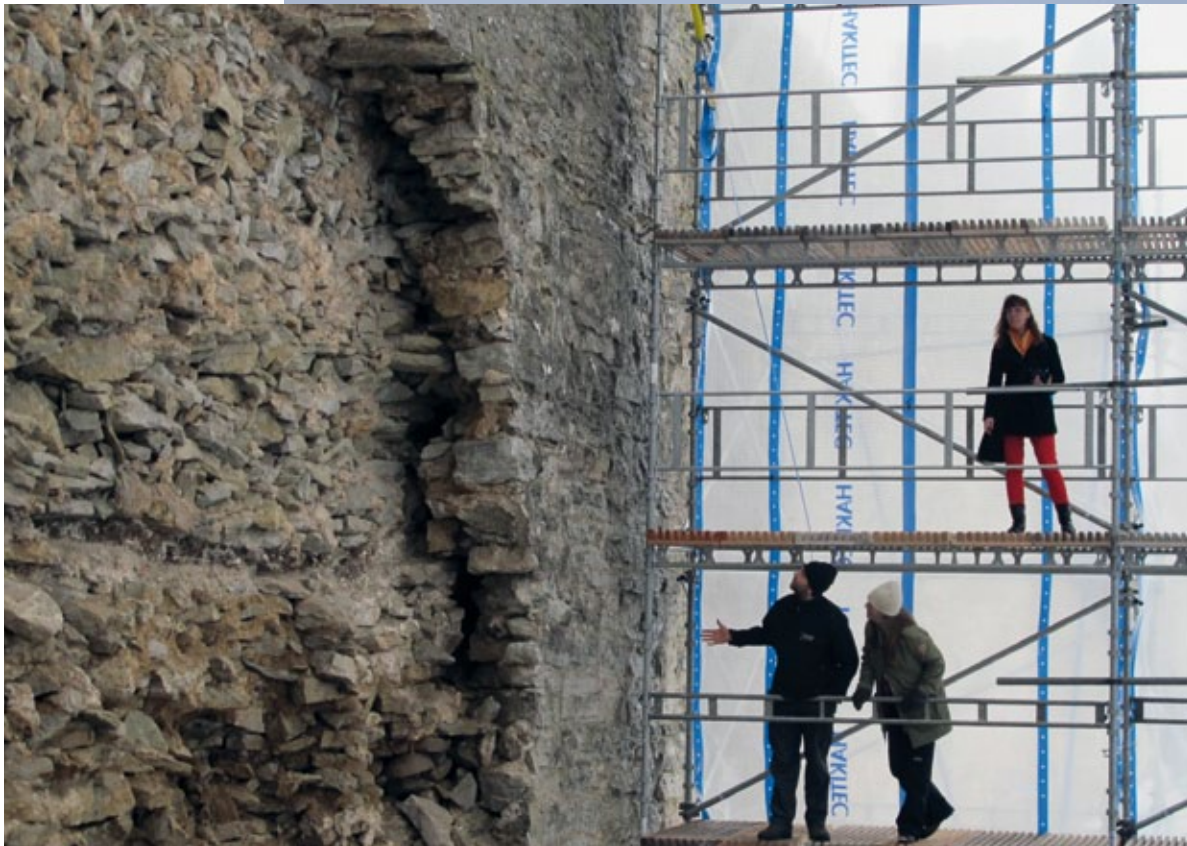
Figur 1.13. Under hösten 2012 monterades ett stort väderskydd med invändig ställning vid raset för att skapa en torr miljö vilket möjliggjorde besiktning och undersökningar. Många diskussioner och funderingar omkring muren och vad som skulle göras avhandlades i detta tält! Foto: Henrik Löwenhamn/RAÄ.
