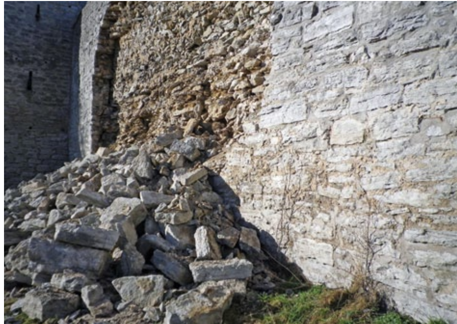
Figur 5.1. Översiktsbilder över raset där cementfogar och kalkfogar existerar parallellt. Det feta kalkbruket finns i hela yttre skalet. Foto: Kristin Balksten.
