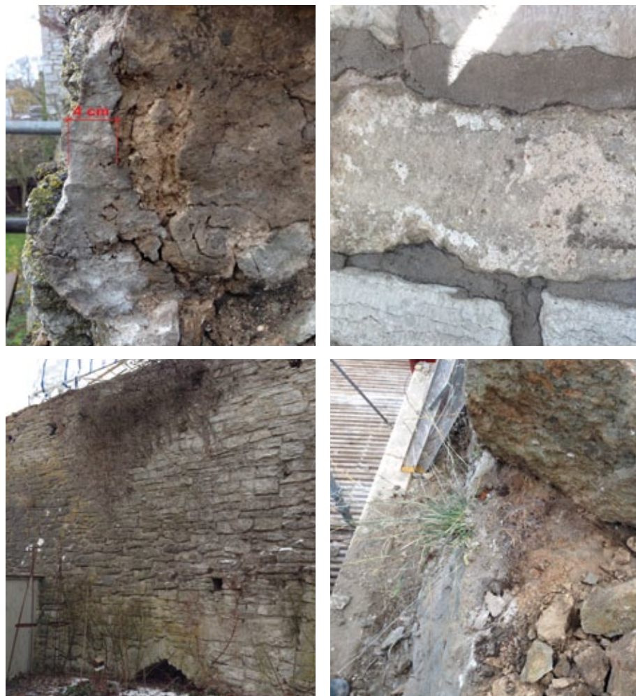
Figur 5.2. Cementfogens tekniska egenskaper gällande styvhet, fukt- och temperaturutvidgningsförmåga och permeabilitet är inte lämpliga på ringmuren vilket yttrar sig genom sprickbildning, ökad växtlighet och urlakade kalkbruk. Foto: Kristin Balksten.
