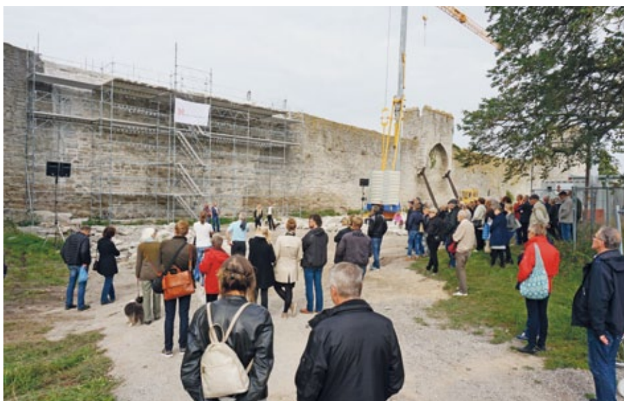
Figur 1.19. Under Visbydagen i oktober 2014 bjöds allmänheten in till Sista Stenen, då hantverkarna Daniel Sjöberg och Thomas Andersson från Byggnadsbyttan berättade om hur det hade gått till att bygga upp muren igen. Christian Britse från Cementa berättade om varför företaget tycker det är viktigt att stödja kulturarvet och projektledare Ulrika Mebus tackade alla för goda insatser. I bakgrunden bakom ställningen kan man se den proffsigt nyuppförda muren. Publikstillströmningen var som synes god. Foto: Henrik Löwenhamn/RAÄ.
