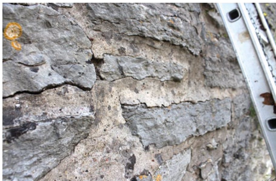
Figur 6.4. Exempel på cementfog som tydligt spruckit ifrån stenen och bildar kapillärsugande kana- ler där vattnet kan tränga in i murverket. Foto: Carl Thelin.
