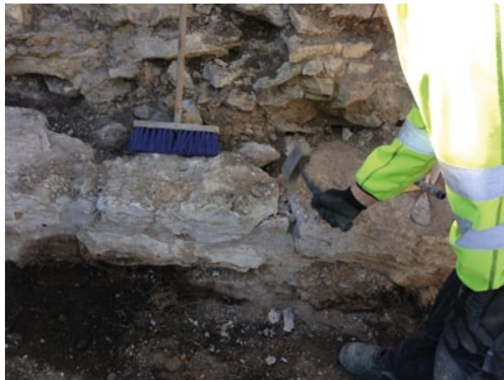
Figur 9.13. Så här långt ner har muren plockats. Nedersta skiftet visar sig vara tomt på kalkbruk i stående fogar, men däremot är det fyllt med rikliga mängder med cementbruk.
