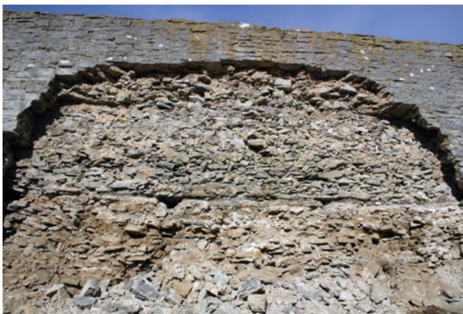
Figur 3.2. Det rasade murpartiet. Foto: Jörgen Renström.
