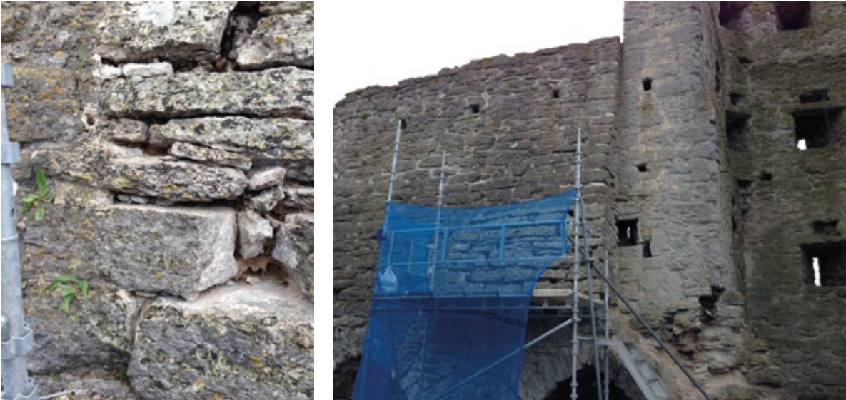
Figur 7.12. Urknackad fog på flaskhalsen visar hur djupt det är till kalkbruket. Bakom cementfogen hade kalkbruket löst upp sig en bra bit in i muren. Foto: Kristin Balksten.
