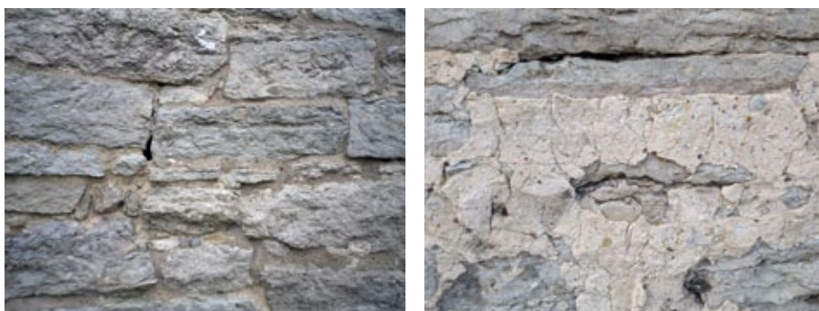
Figur 5.3. De gamla kalkfogarna som finns på muren skiljer sig tydligt till karaktär mot de sentida cementfogarna, vilket även blir en tydlig estetisk påverkan på muren. Foto: Kristin Balksten.
