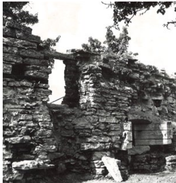
Figur 2.6. Fotografi från 1969, det sista året med donation från Cervin, från insidan av sjömuren vid fastigheten Fregatten 11 i Almedalen. Muren är i uppseendeväckande dåligt skick vilket indikerar hur stort och akut behoven varit på andra håll tidigare under 1900-talet. Efter restaureringen av detta muravsnitt hade alla de mest skadade delarna av muren åtgärdats. Foto: Gotlands Museums arkiv.
