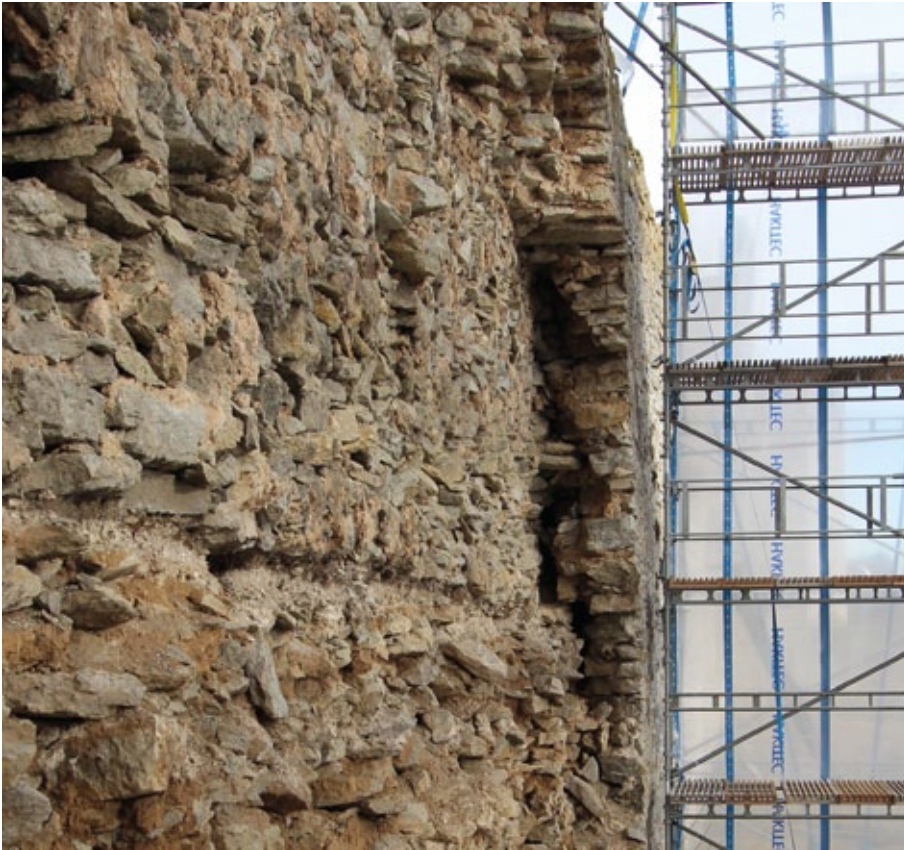
Figur 8.18. Norr om raset gick det tydligt att se stora hålrum mellan det yttre murskalet och murens kärna. Foto: Carl Thelin.
