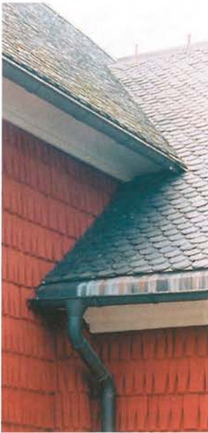
Det nuvarande utseendet på takfoten med fult randad kopparplåt. Märk den tättslutande rännaldalen, tillkommen vid en omläggning på 1950-talet.
