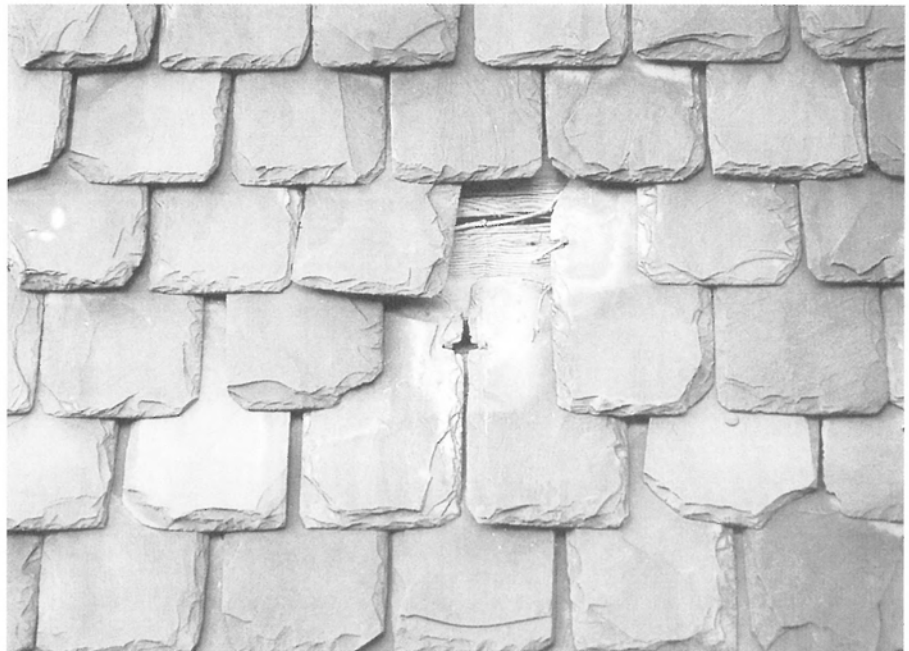
Dalslandsskiffer spikad i bak. Fasadbeklädnad på ett timmer- hus i Flathult, Dalsland.
