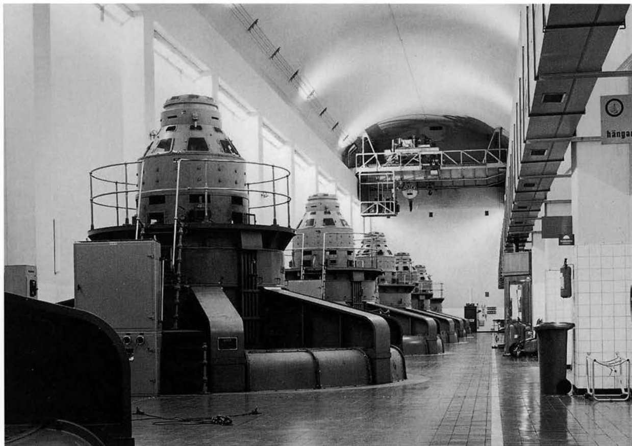
Interiör från den väldiga underjordiska maskinsalen i Krångede II:s kraftstation med sex vertikala maskinaggregat uppställda i en prydlig rad. BS 1992.
