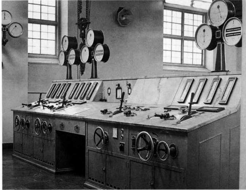
Manöverpulpet och synkronoskop i Forshuvudforsen I:s kraftstation med blanka ratar, rejäla handtag och lättöverskådliga visarinstrument. BS 1992.
