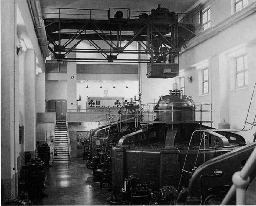
Maskinballen i Forshuvudforsen I. De stora vertikala generatorerna med slutna ventilation och övre bärlager är placerade över golvplanet. Magnetiseringsström erhålls från roterande omformare som står på golvet mellan generatorerna. Manöverbalkongen syns i fonden. BS 1992.
