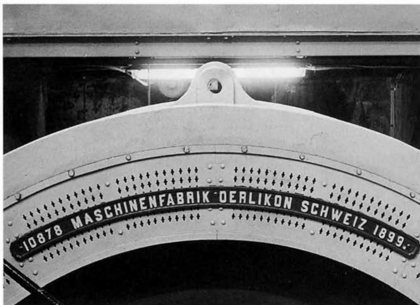
Tillverkningsskylten på 1899 års generator i Kvarnsveden I. BS 1992.
