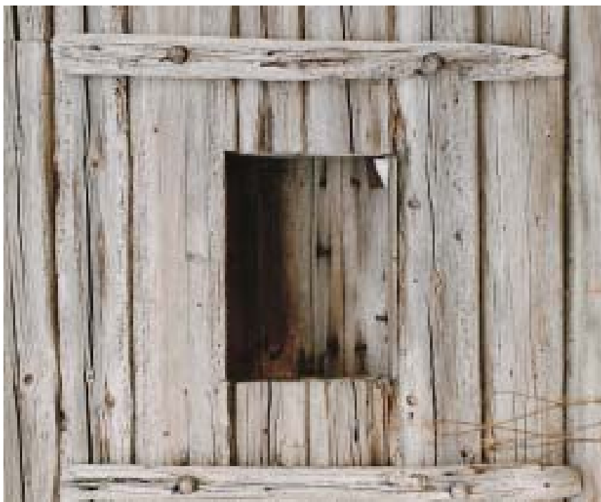
Vädringsluckor bör stå på glänt för att medge självdrag.
