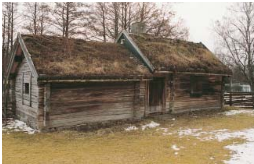
Gammelstugan. Vid taknocken på den högra halvan av byggnaden syns plastmattan. Fönsterluckorna är tätt tillslutna och samtliga gavelgluggar är igenspikade.
