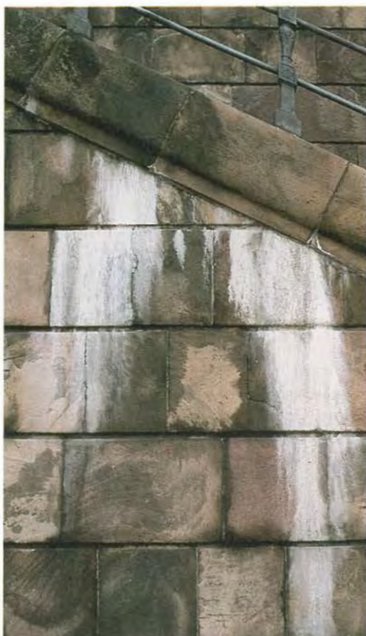
Figur 81. Svärtning och kalkkrinningar från fogar på Kungl. Slottets nordvägg mot Slottskajen. Bergart Roslagssandsten. Foto B.A. Lundberg 1991.
