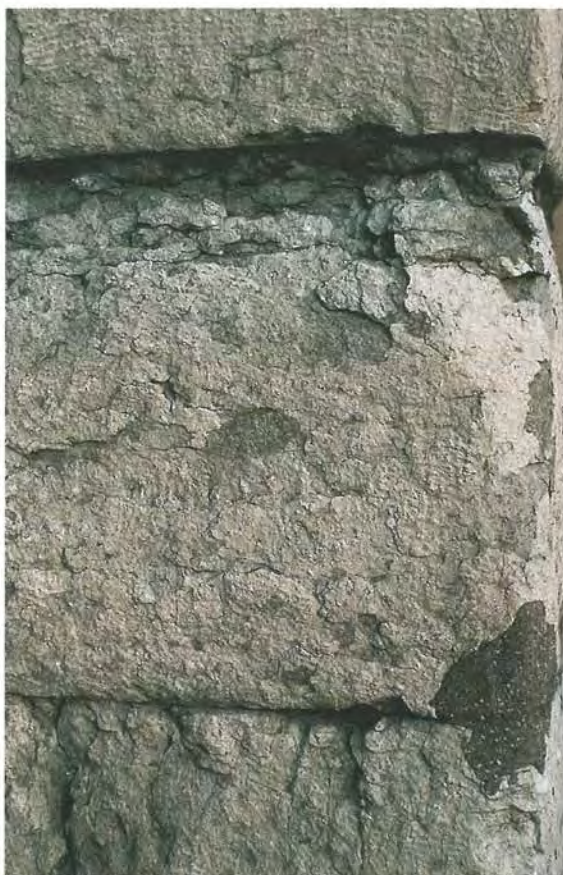
Figur 93. Nedbrytning i form av kantavrundning samt lagat mörkt parti i Yxhultskalksten på Strandvägen 17, Stockholm. Foto B.A. Lundberg 1991.
