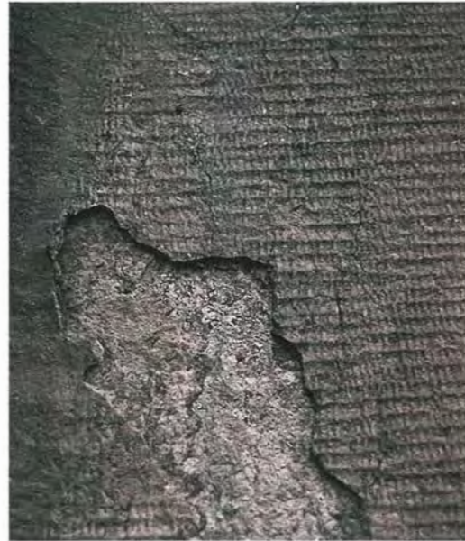
Figur 87. Tandhuggen Yxhultskalksten på Vetlanda kyrkas västportal, från 1903, med sprickor, bompartier och ett exfolieringssår. Foto R: Löfvendahl 1993.
