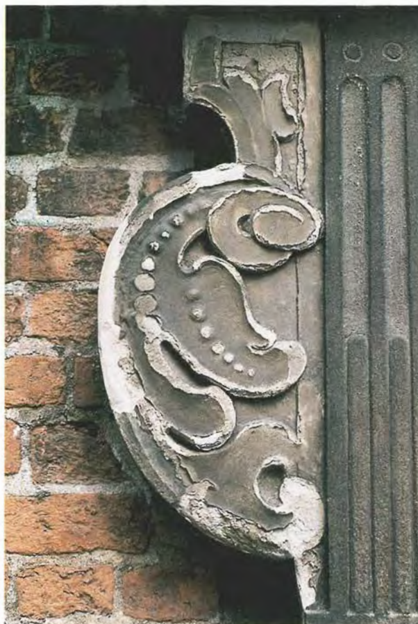
Figur 94. Konsol på västportalen, Trefaldighetskyrkan i Kristianstad, Skåne av gotländsk sandsten. Tät svart hinna på ytan där exfolieringen initierats från kanter och ger en ljus sandande yta. Foto B.A. Lundberg 1992.
