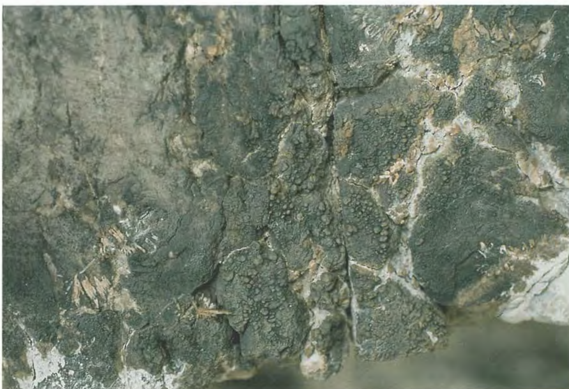
Figur 96. Svärtad vårtig gipskrusta och kvarvarande fäströtter av murgröna i grå gotländsk kalksten på S:t Nicolai kyrkoruin, Visby. Foto B.A. Lundberg 1991.
