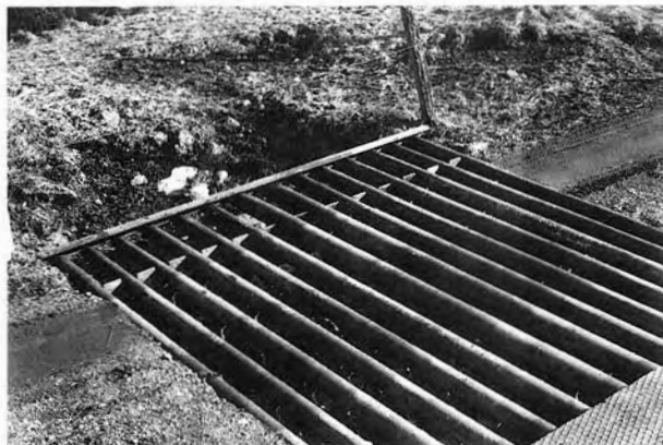
En riktigt byggd färist fungerar som utmärkt grind över trafikerade vägar. Denna rist är gjord av järnrör som hindrar djuren att passera.
