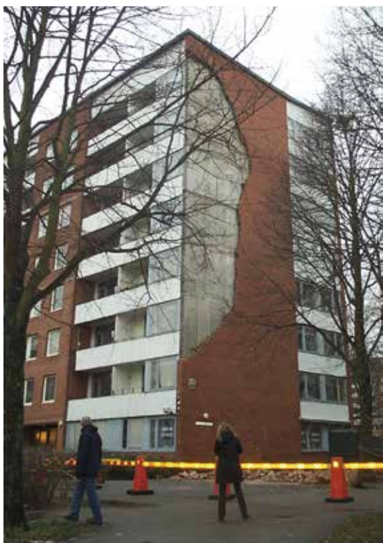
Ras förorsakat av korrosionsskador i tegelfasad på Klostergården i Lund, i samband med stormen Gudrun år 2005. Fasadras av liknande omfattning kan inträffa även utan kraftiga vindar. Foto: Tomas Gustavsson.
