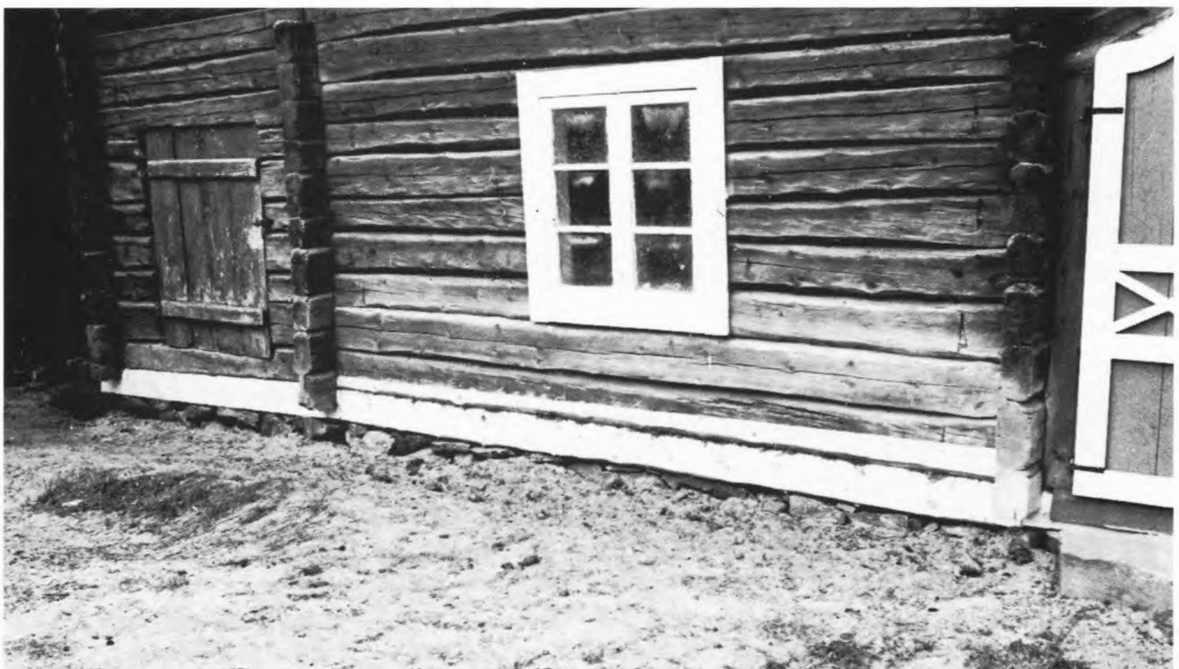
Det understa stockvarvet rötskadas ofta, särskilt när sockelhöjden är låg. Syllstocken är här utbytt. Det är bra att fotodokumentera skadorna och arbetet fram till färdig lagning. Foto Jämtlands museum.
