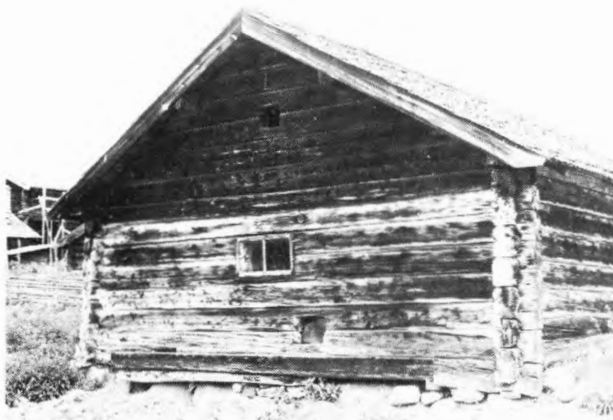
Bilden ovan: Djurstall med rötskadat timmer och en gavel som visar tendens att bågna. Foto RAÄ.
