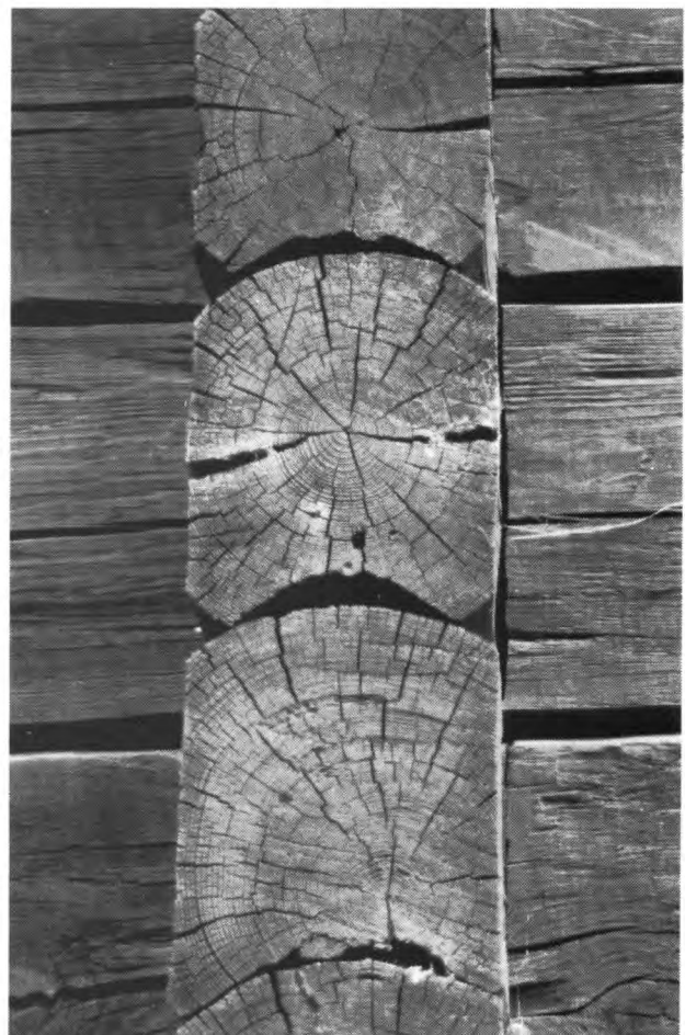
Mellanväggsknut, draget syns tydligt. Foto Uno Söderberg.
