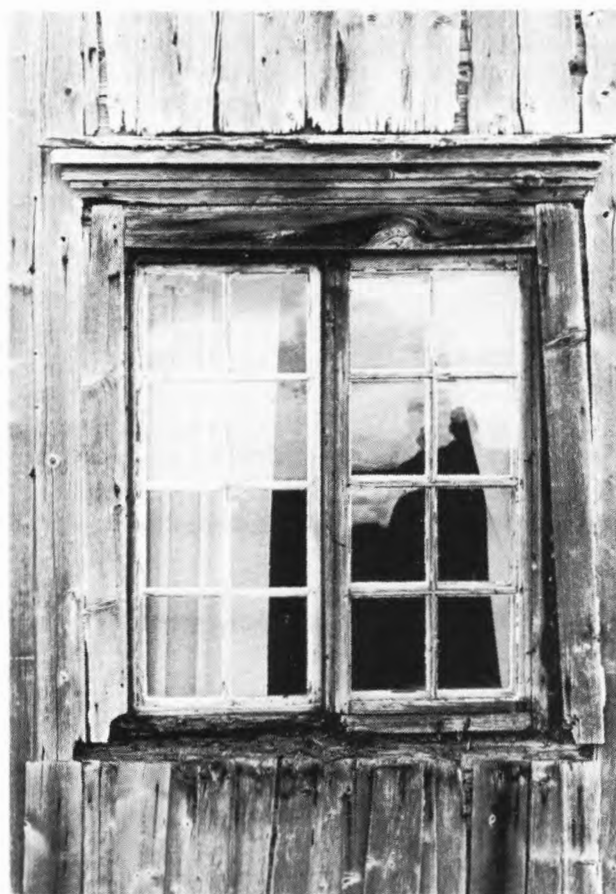
Underkant fönster är ett ställe där skador ofta förekommer. Regnvatten samlas på fönstren och rinner in i olika fogar vid mötet mellan fönstersnickeri och timmerstomme. Foto C Lindström, Jämtlands läns museum.
