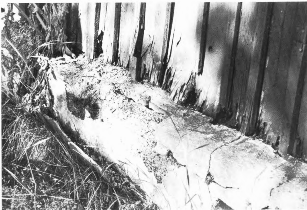
Olämpligt utförda reparationer kan förorsaka omfattande skador. Bilden visar rötskador som uppkommit på grund av att en sockel gjutits upp över panelens nedre del. Foto RAA
