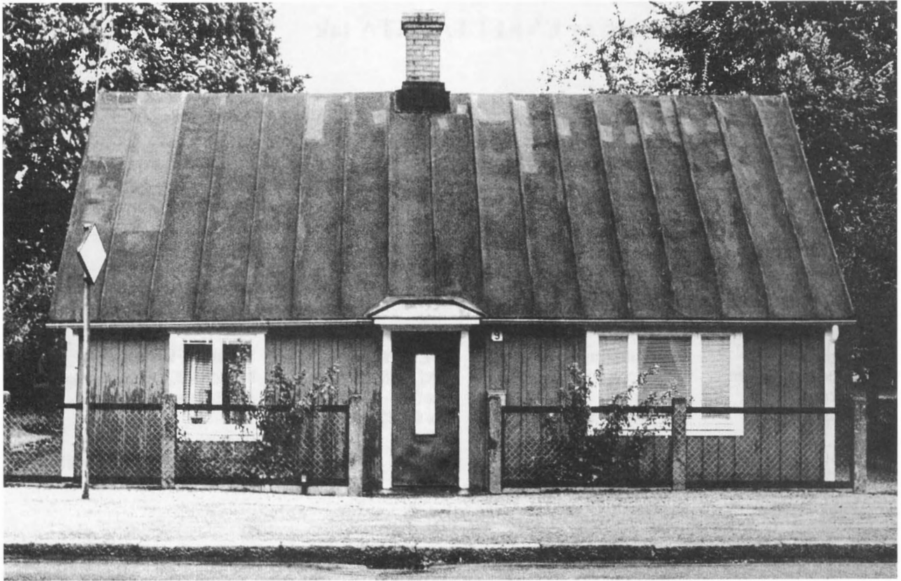
Ett omsorgsfullt, men ej helt korrekt utfört lagningsarbete på ett listtäckttak. I stället för ovanpåliggande lappar bör våden bytas ut i hela sin bredd och listerna täckas av en täckremsa — se sid 24 och 29. Foto 1983, Magnus Lindhagen.
