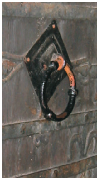
Järnring som rostet.
