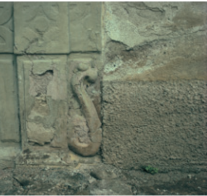
Saltsprängning i sockel orsakad av saltning.
