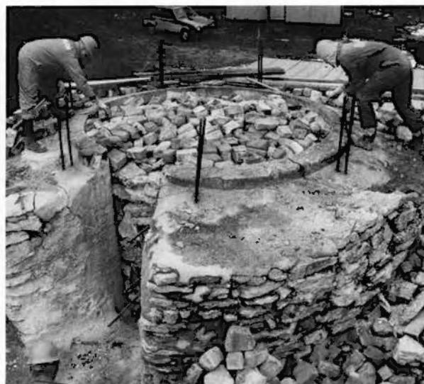
När ugnsippan är fylld med kalksten täcks hela insättningen med två lager eldfast tegel.
