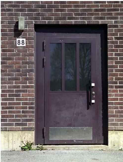
Ingång från gårdssidan sakligt infogad i sockelns murförband. Den ursprungliga trädörren är utbytt mot en ståldörr med armerat glas.
