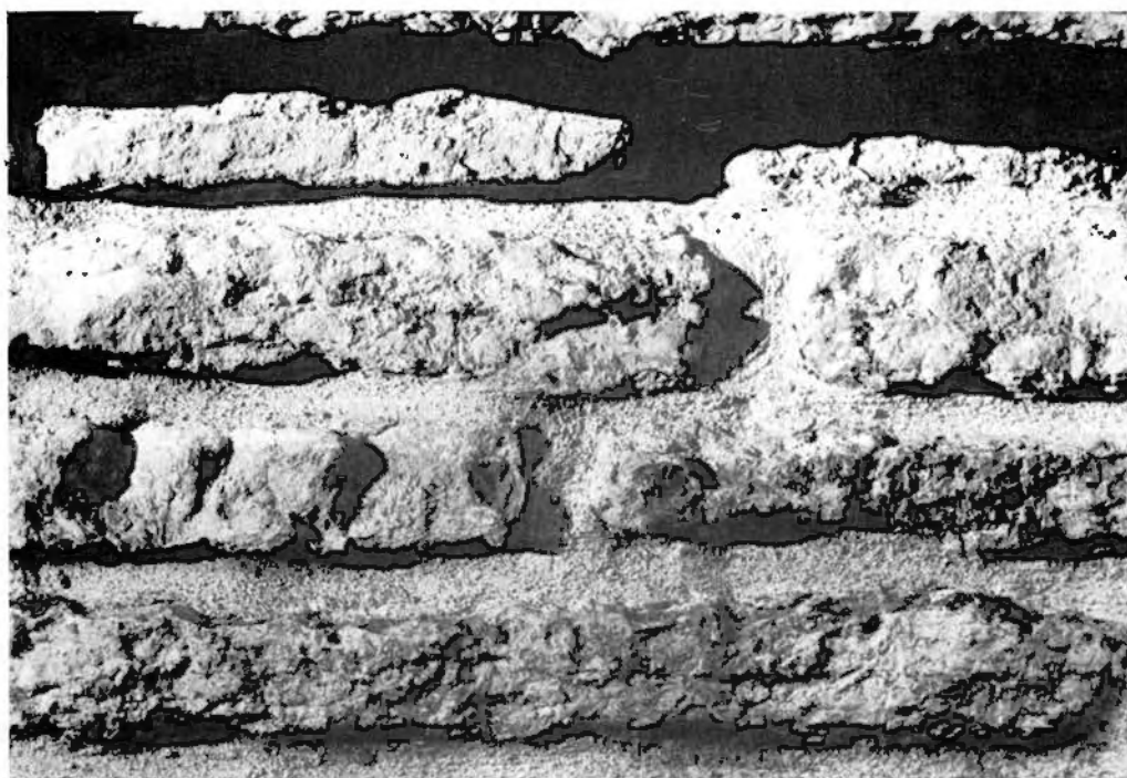
Bild 2, Kallmur vid Varnhems klosterruin fogad med kalkbruk 1976. Från början var det tänkt att ett avsnitt om fogningsarbeten i fasad skulle ingå i denna rapport. Foto 1981, Arksam AB.
