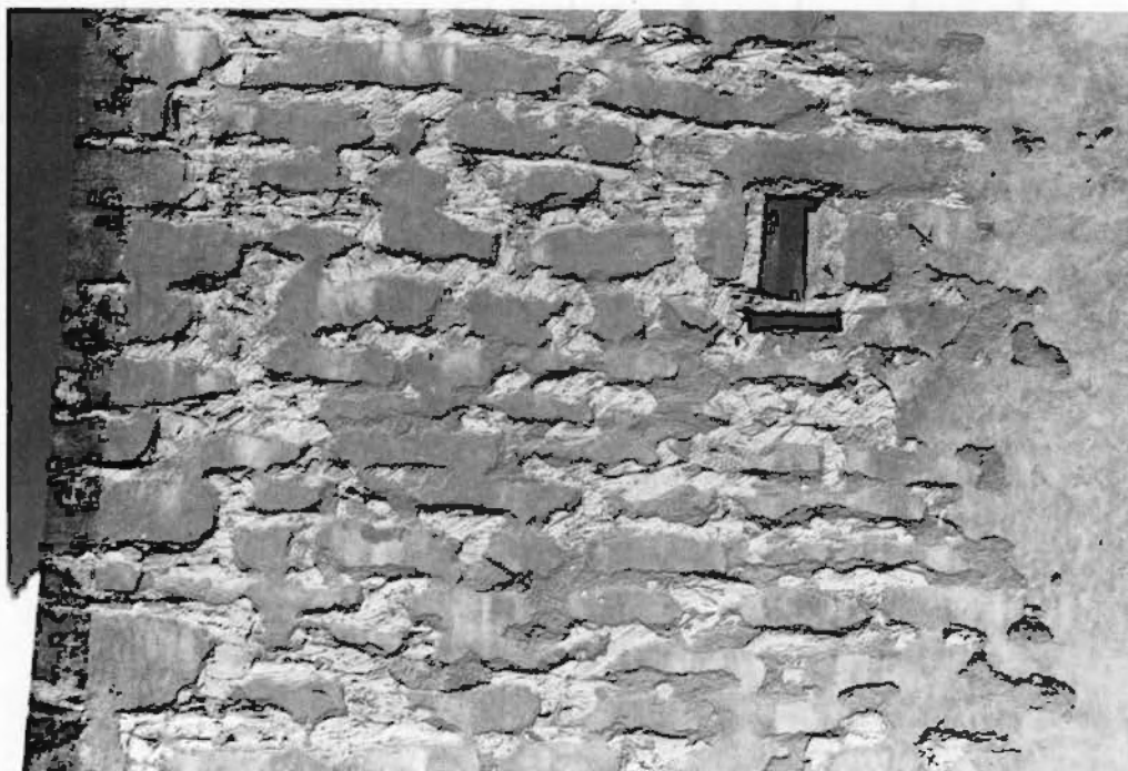
Bild 15, Tornet på Ardre kyrka putsades om 1974. Murverket var då mycket fuktigt. Frysning etc har medfört putsnedfall koncentrerat till fogarna, som haft lättast att transportera fukten. Foto 1981, Arksam AB.
