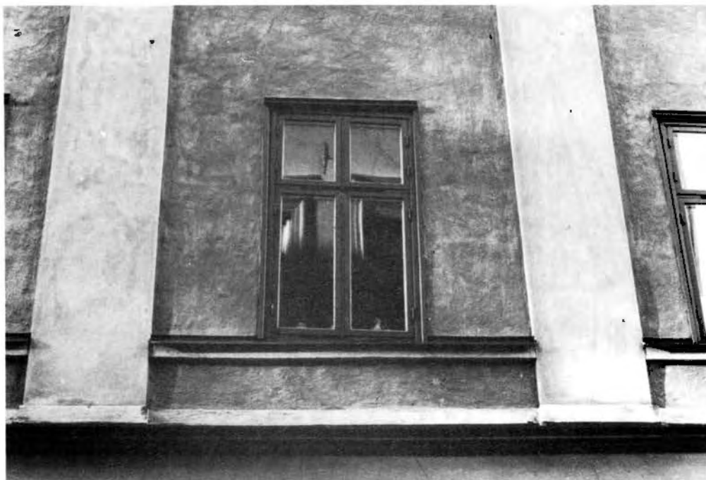
Bild 28, Det är inte ovanligt att en kalkavfärgad fasad vittrar. När det sker långsamt med åren, upplevs det ofta som en naturlig patina. Snabbt uppkommen vittring uppfattas däremot som en skada. Lilla Nygatan 8 i Stockholm, putsad 1972. Foto 1981, Arksam AB.
