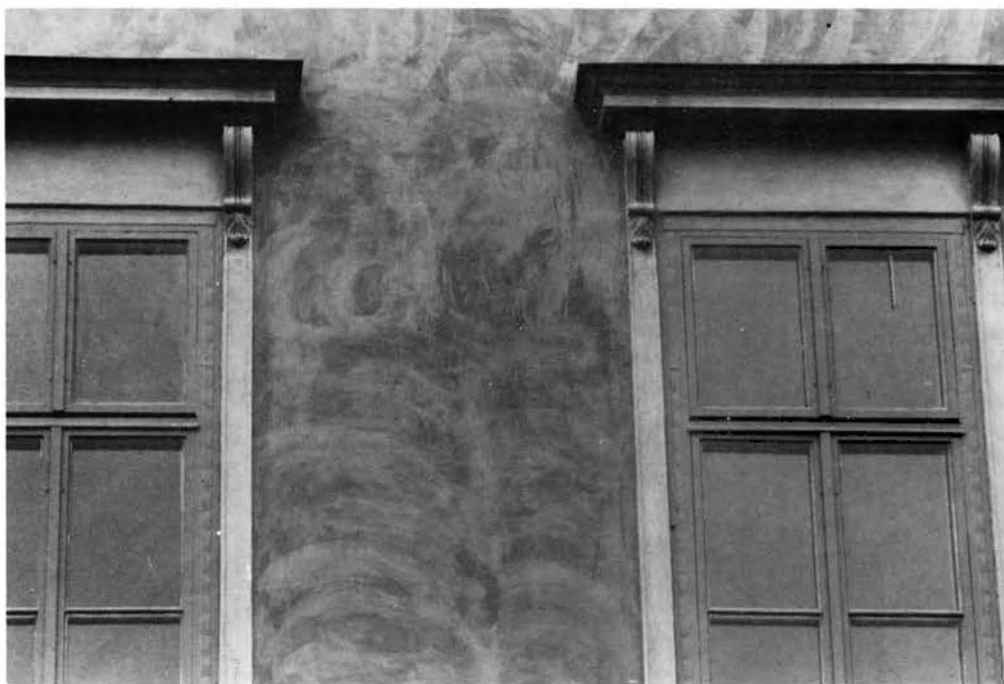
Bild 11, Ojämna kulör, i detta fall orsakad av felaktigt arbetsutförande. Foto 1981, Arksam AB.
