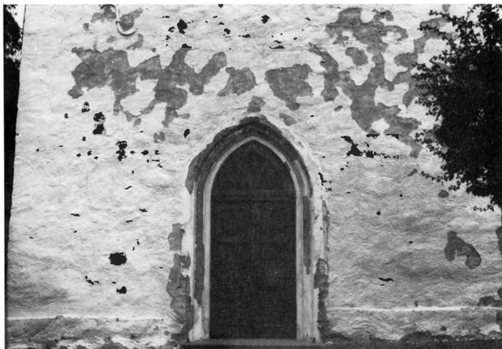
Bild 3, Putsnedfall är en påtaglig skada, lätt att konstatera även för en lekman. Foto 1981, Arksam AB.
