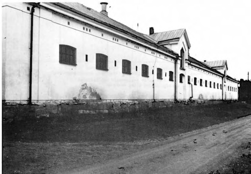
Bild 19, Vitträd avfärgning, orsakad av urin och gödselhantering. Stallbyggnad vid Strömsholm, putsad 1974. Foto 1981, Arksam AB.
