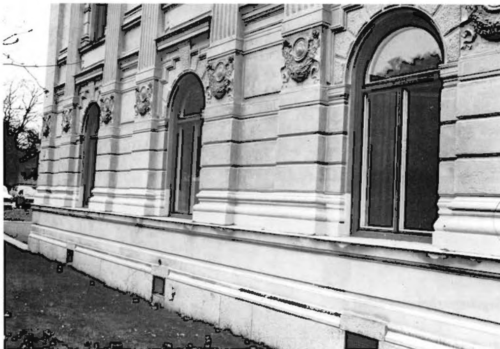
Bild 18, Missfärgad puts under liståvtäckningens skarvar, orsakat av att plåtarna ej är falsade utan endast lagda omlott. Köpings tingshus, putsat 1974. Foto 1981, Arksam AB.
