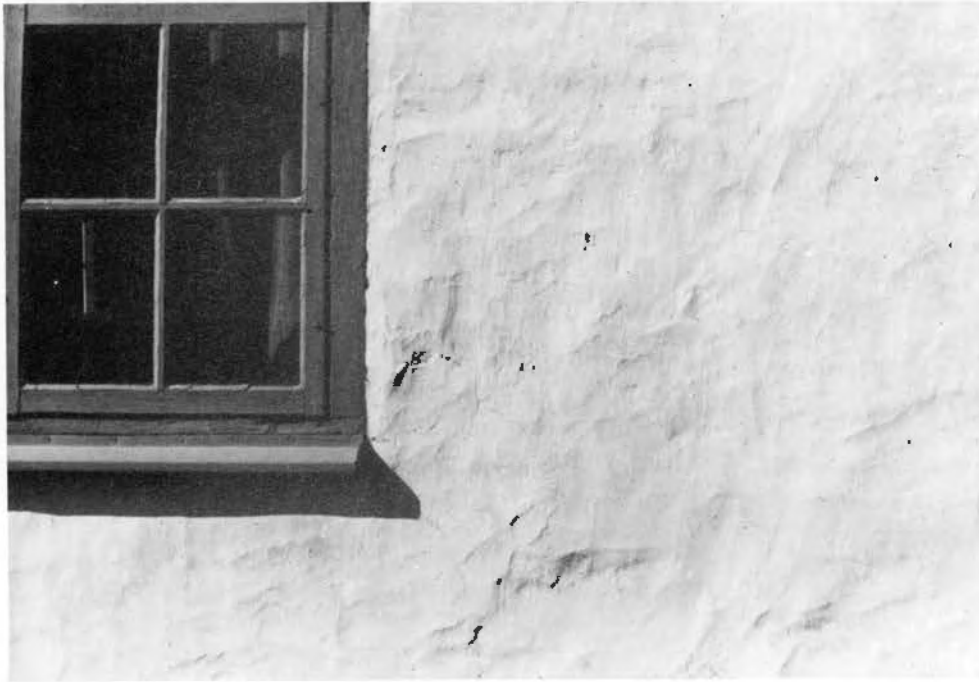
Bild 29, Kalkputsad vägg som med gott resultat slevslätats på traditionellt vis. Foto 1981, Arksam AB.
