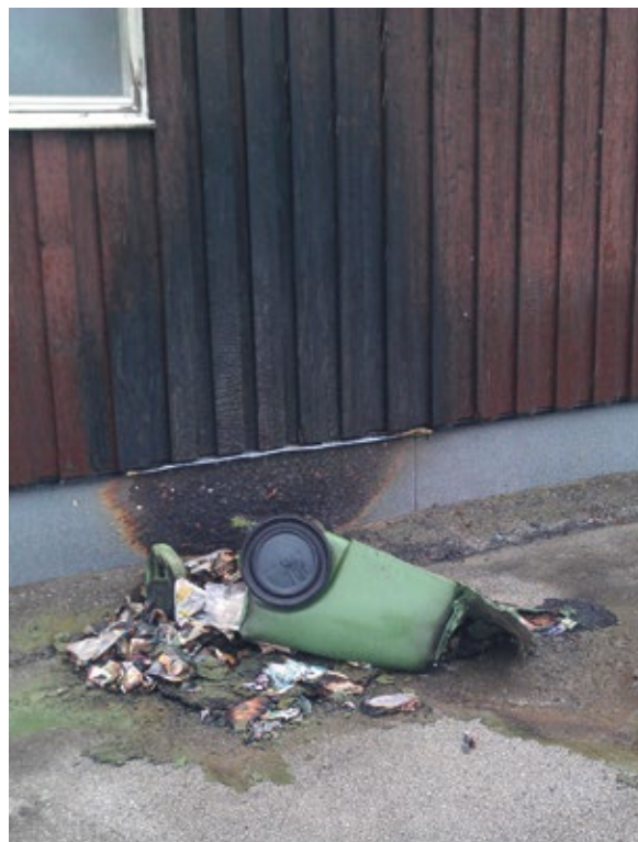
Anlagd brand i soptunna kunde ha spridit sig till huset. Foto: Erika Hedhammar/Riksantikvarieämbetet.
