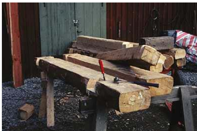
Nybilat timmer för utbyte av rötskadade syllstockar vid Mjölnergården i Djurgårds- staden i Stockholm. Timmerstommens fördel är den att skadade delar med relativt begränsade insatser kan bytas ut utan risk för att byggnaden skadas. Foto: OAn
