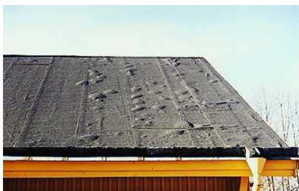
Kraftig blåsbildning under tätskiktet på det pappklädda taket. Foto: BBj
