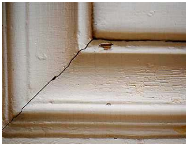
Linoljefärg på invändigt snickeri 50 år efter målning. Färgskiktet spricker i ett för linoljefärg typiskt mönster i avlånga flagor. Se även bild vid "Skadeorsaker". Foto: KKLy
