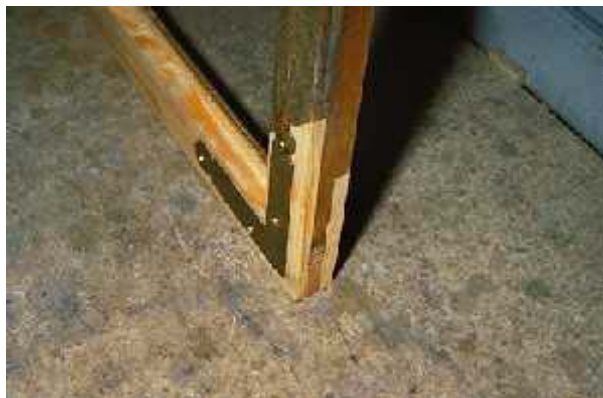
Skadat trä kan alltid ersättas. Bottenstycken och spröjsar kan ibland få mindre rötskador. Bilden visar en av Drottningholmsteaterns mer än 200 år gamla fönsterbågar efter reparation. Foto: OAn
