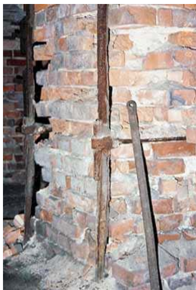
Vittrande tegelmurverk som delvis hålls samman av den frilagda järnkonstruktionen. Foto: MTö
