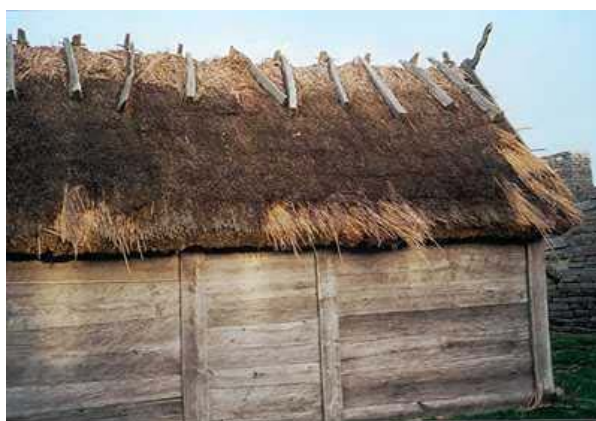
Skador på läsidan av ett stråtak efter en storm med över 30 m/s. Foto: EAr
