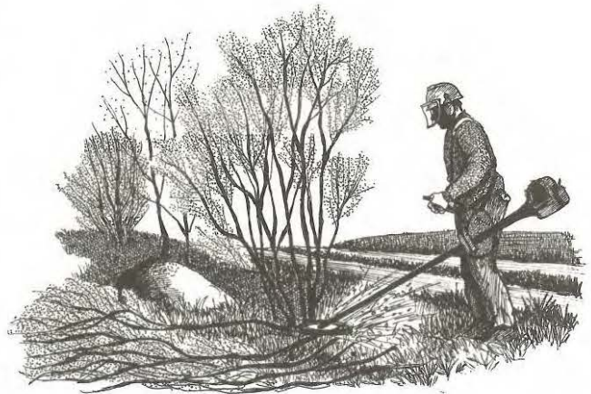
Röj buskar och sly i vägrenarna och mittsträngen.
