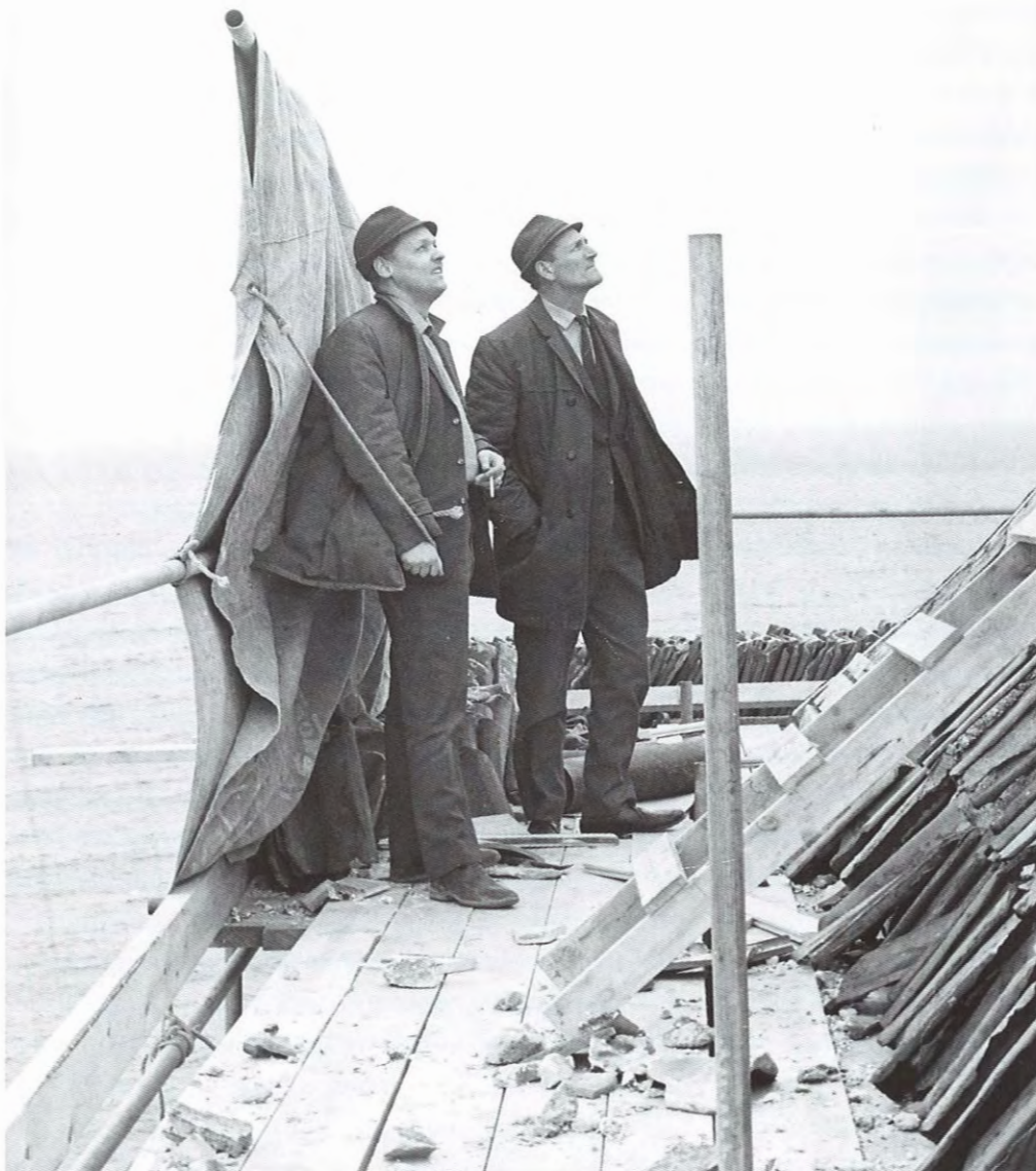
David Simander (t.h.) och ingenjör Holger Ericsson inspekterar omläggningen av taket på Kruttornet i mars 1967.
