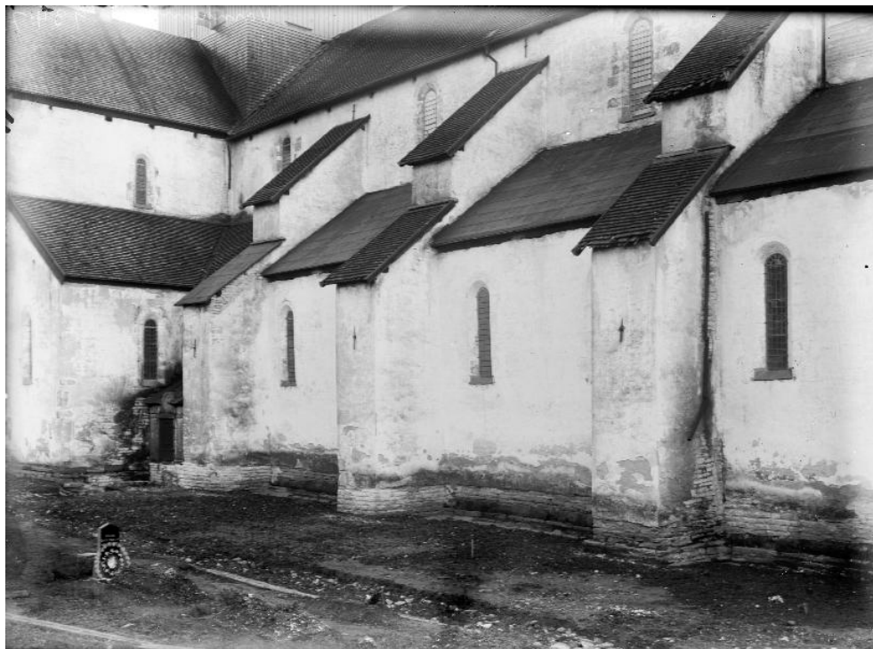
Varnhems klosterkyrka, Del av norra fasaden och sakristian före putsavknackning. Fasaderna svårt skadade av trasiga stuprör och fukt från marken. Foto: Axel Forssén, Riksantikvarieämbetet.
