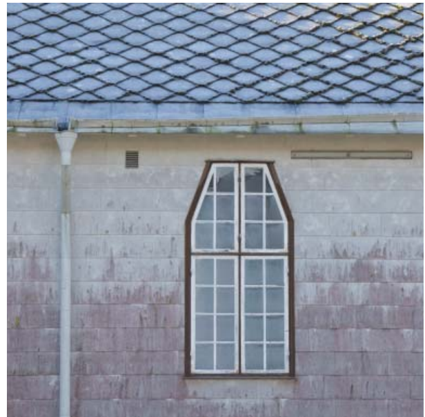
Asbestcementplattor kom att användas både som tak- och väggbeklädnad och sågs som näst intill underhållsfritt. Detaljbild Orgelmuseet i Vänge. Foto: Helena Duvenborg
