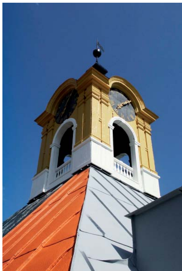
Vasatornet, Rydboholm med blymönja på takfall med äldre svartplåt och zinkfasfatfärg på galvaniserad plåt.
