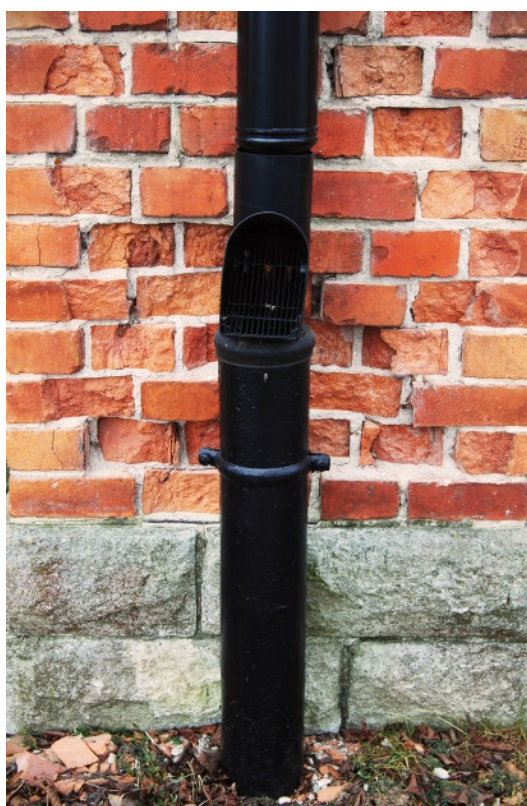
Frostsprängt tegel. Vatten har läckt från ett äldre trasigt stuprör och orsakat frostsprängning. Foto: Helen Simonson.
