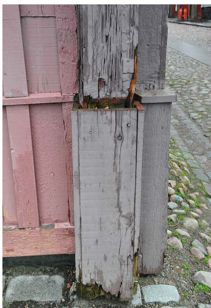
Rötskadad knutlåda, Mäster Mikaelsgata, Stockholm. Vikten av kontinuerlig översyn av materialen, ytskyddet (till exempel färg) samt förutsättningarna på plats är mycket viktigt för att undvika och förebygga onödiga skador av typen som syns på bilden. Foto: Helen Simonsson.
