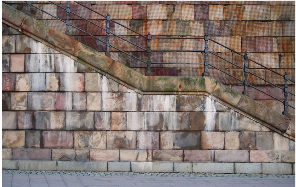
Saltutfällningar och biologisk påväxt på trappa vid Kungliga slottet i Stockholm. Foto: Helen Simonsson.
