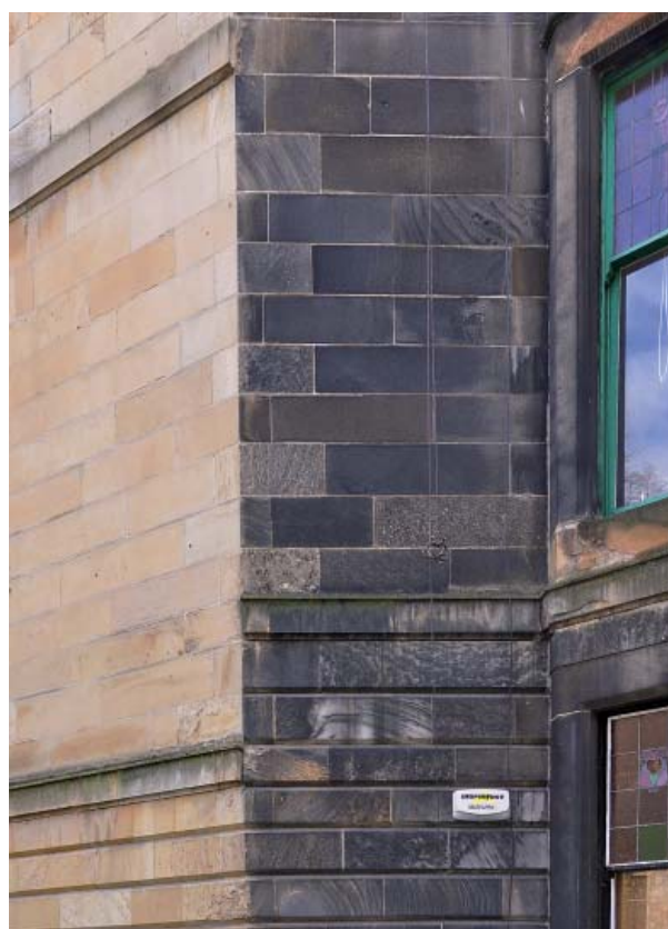
En sandstensfasad i Glasgow som är rengjord till hälften. Kontrasten är mycket stor mellan de svarta, smutsade och de ljusa, rengjorda partierna. Att stenen blivit svart berodde mycket på de fossila bränslen som användes under 1900-talet. Foto: Helen Simonsson, Riksantikvarieämbetet.
