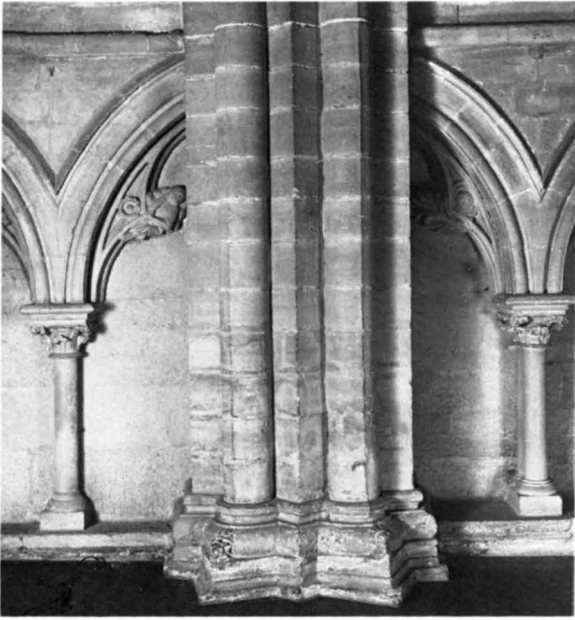
Fig 179. Bågställning nr N6 med väggpelaren A2. Foto A Gustafsson, Studio östgöta-bild 1975. ÖLM.
