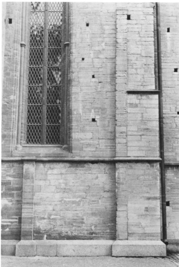
Fig 39. Rester av ursprunglig fasaddekor i form av lisener på tvärhusets norra sida i travé 7. Foto K Hallin 1986.
