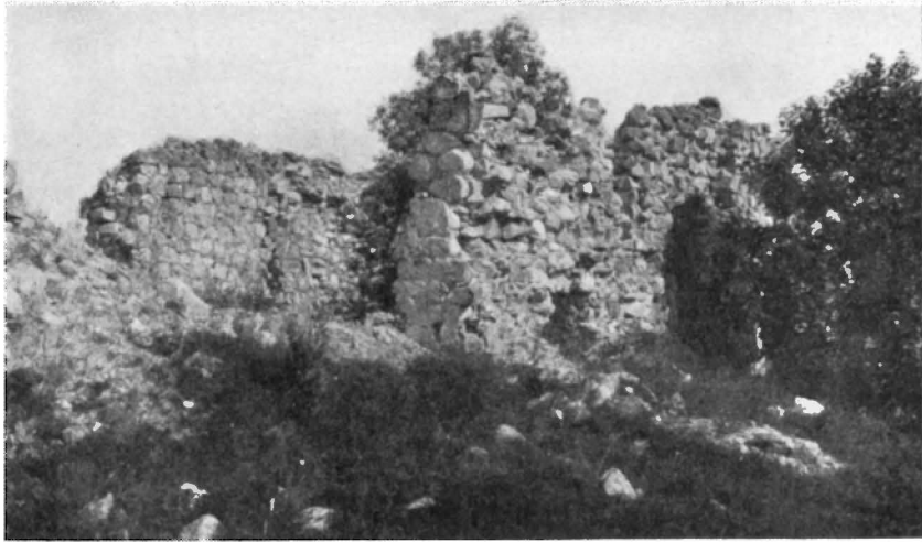
Fig. 10. Njurunda gamla kyrka. Sydmurens västra del. Die alte Kirche zu Njurunda. Westlicher Teil der Südwand. The old church of Njurunda. Western part of the south wall.
