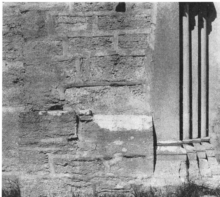
Fig. 391. Korportalens V smyg och hörnmuren därintill. Obs. sockelstenen. Foto 1928. Westlaibung des Chorportals und Teil der Chorwand. In der Mitte des 13. Jahrh. bestand die Absicht das Langhaus zu erweitern. Das Sockel-Profil wurde diagonal geschnitten, sodass ein anderer Sockelstein sich im rechten Winkel anschliessen konnte. Der Sockel wurde jedoch nicht vollendet, da der erwähnte Erweiterungspan nie durchgeführt wurde. Left jamb of chancel doorway and part of chancel wall. In the mid-13th century, the intention was to widen the nave. The socle-stone in the picture was cut on the splay, so that it could join another at right-angles. The socle however was not completed, because the above-mentioned building programme was never accomplished.
