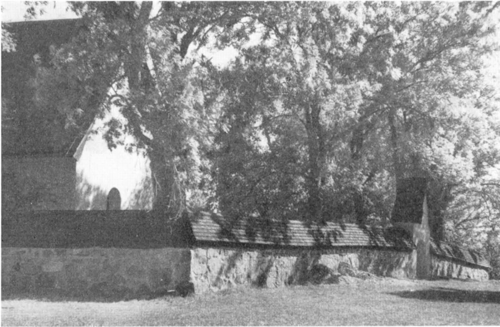
Fig. 295. Kyrkogårdsmurens NV hörn. Foto 1947. Nordwestecke der Kirchhofmuer. N. W. corner of the churchyard wall.
