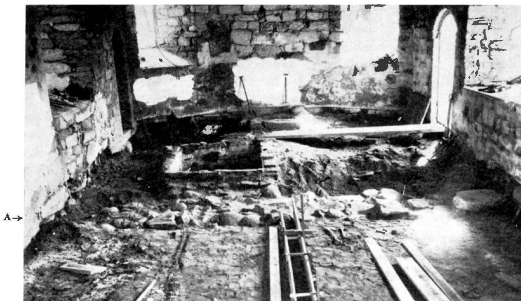
Fig. 10. Foto av den vid A framgrävda grunden till långhusets urspr. Ö-mur, sedd från V. En murad gravkammare synes Ö om denna. Foto A. Tell 1950.
