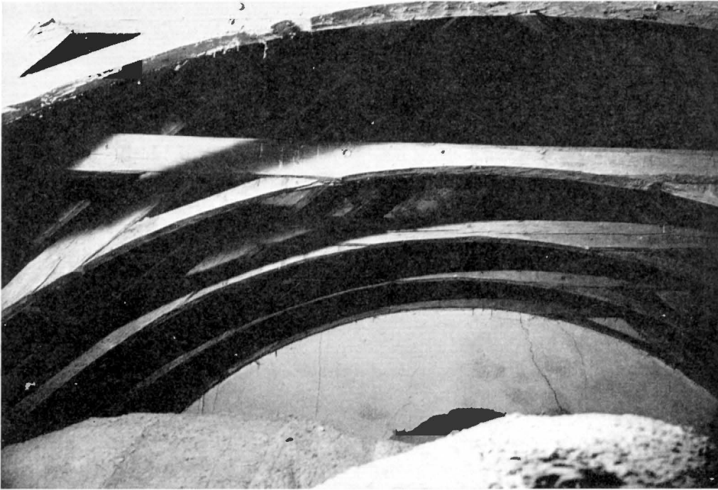
Fig. 35. Kyrkvinden över N tvärskeppet med bevarad takstolskonstruktion för tunnvalv av trä. Dachboden über dem N Querschiff mit Dachstuhlkonstruktion für Holztonnengewölbe. Attic above N transept with roof timber construction for wooden barrel-vault.
