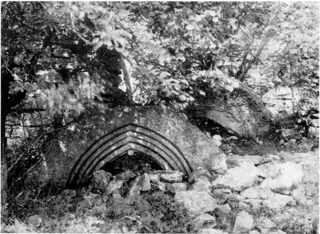
Fig. 912. Långhusets S ingång med nedfallna portalstenar, före reparationen 1948. Foto A. Edle 1922. S Eingang des Langhauses mit herabgefallenen Portalsteinen vor der Instandsetzung von 1948. S entrance to nave with fallen stones from doorway, before restoration 1948.
