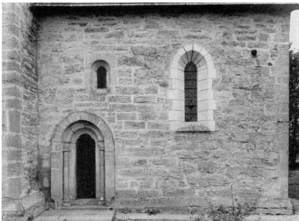
Fig. 853. Korets S fasad. Foto A. Edle 1948. Die S Seite des Chors. Chancel façade.
