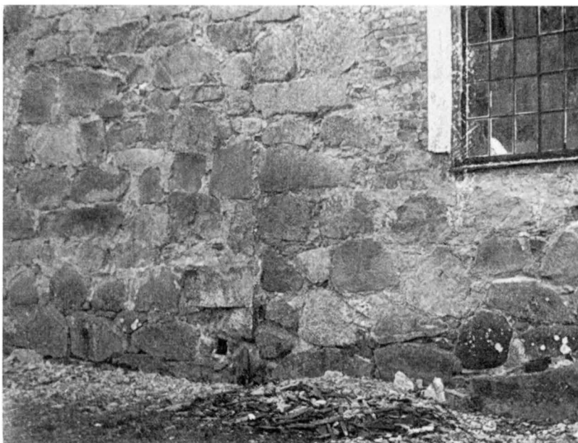
Fig. 24. Murskarv i N-muren (vid x å fig. 7) efter det äldsta långhusets utsträckning mot V. Foto E. Bohrn 1951, ATA.
