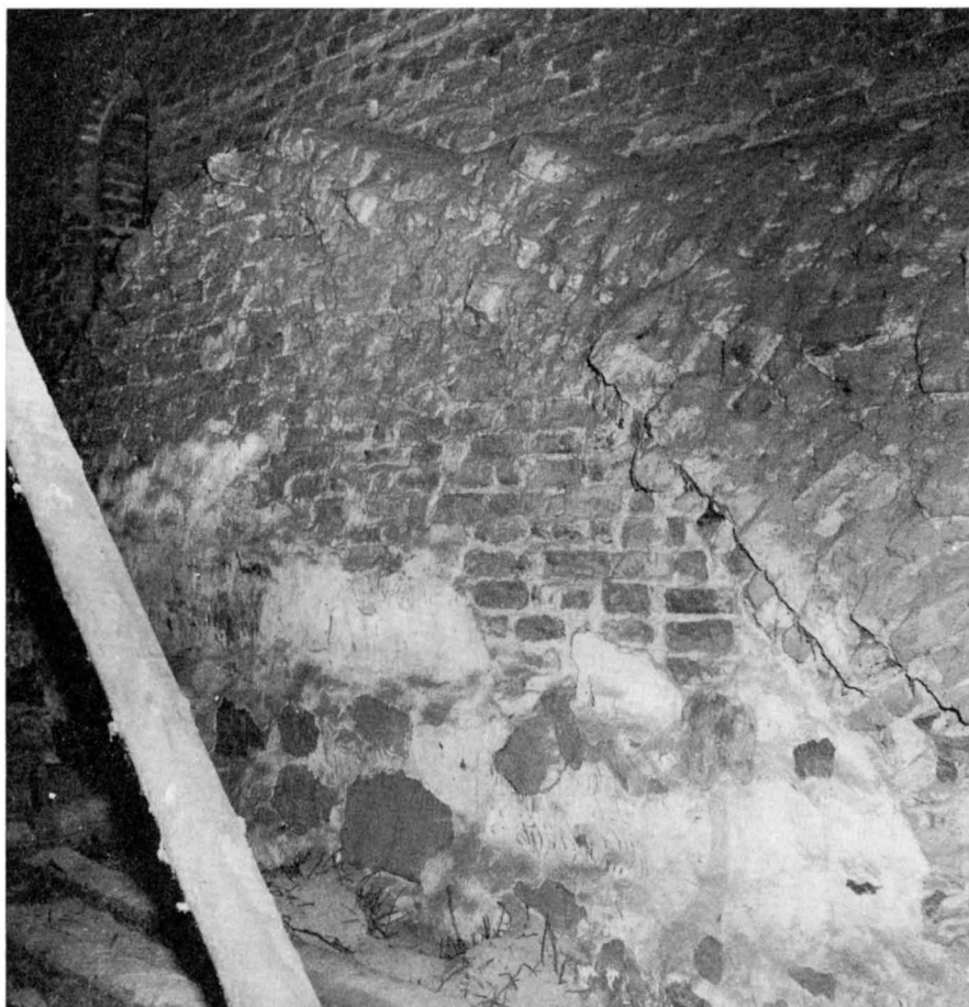
Fig. 25. Spår av äldre tegelvalv å V gavelröstets insida. Foto I. Rosell 1965. S. 24. Traces of older brickwork vaulting on inside of W gable.
