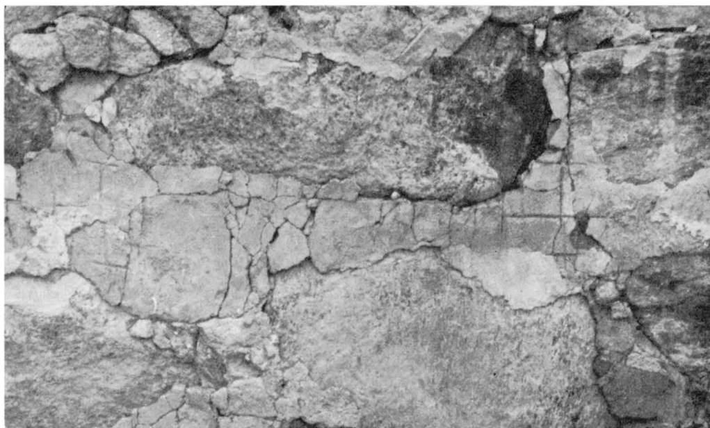
Fig. 774. Putsrester med kvaderristning och kors på korets S vägg. Foto R. Norberg 1934. Putzreste mit Kreuz- und Quaderritzung auf der südl. Chorwand. Remains of plastering with tooled ashlar walling and crosses, on S wall of chancel.
