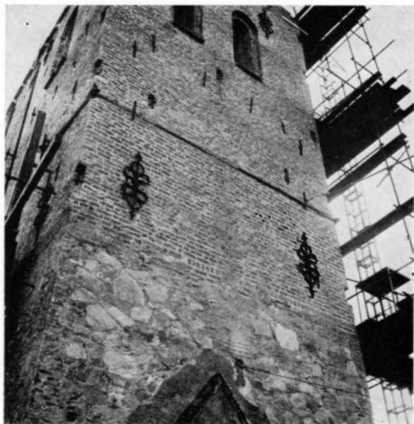
Fig 74. Detalj av tornet från norr, visande skadat och omsatt romanskt gråstensmurverk samt senmedeltida tegelmurverk. Foto Smål Mus 1958.
