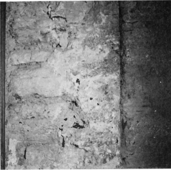
Fig 137. Detalj av tornbågens södra, inåt långhuset vända vederlag med sekundär omfattning av finhuggna kvadrer, som sedermera arbetats över, för att putsen skulle fästa bättre. Spår av kvaderrits på det ursprungliga murverket t v (jfr fig 32). Murverket inne i tornbågen från 1795 (jfr fig 52). Foto R Boström 1969.
