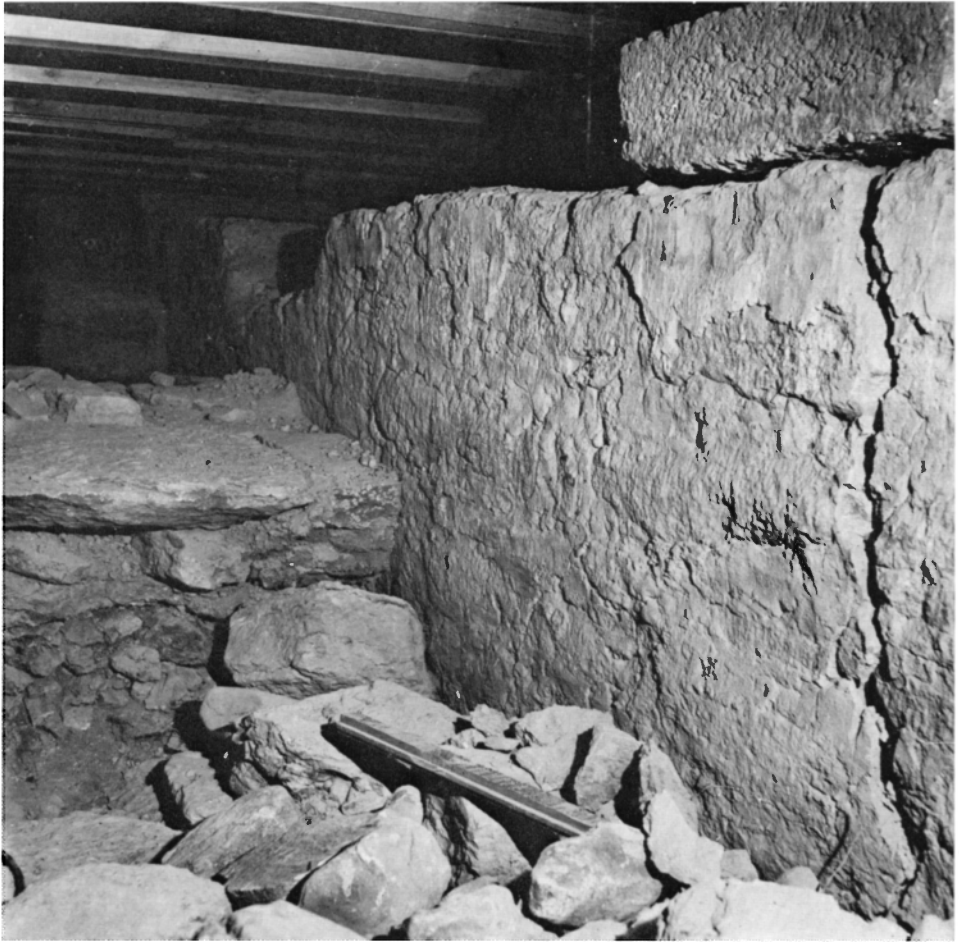
Fig 91. Ett parti av östtornets nordmur (jfr fig 17, 26, 82) med en genomgående sättspricka. På muren ligger ett hugget kvadratisk stenblock, som möjligen har tillhört en mittpelare i triumfbåge nr 3 (jfr fig 82 F, 153). Tv ett stycke av korpodiet (jfr fig 119, 127, 128). De stora kullerstenarna i förgrunden har ursprungligen utgjort grund i podiet. Foto R Boström 1970.
