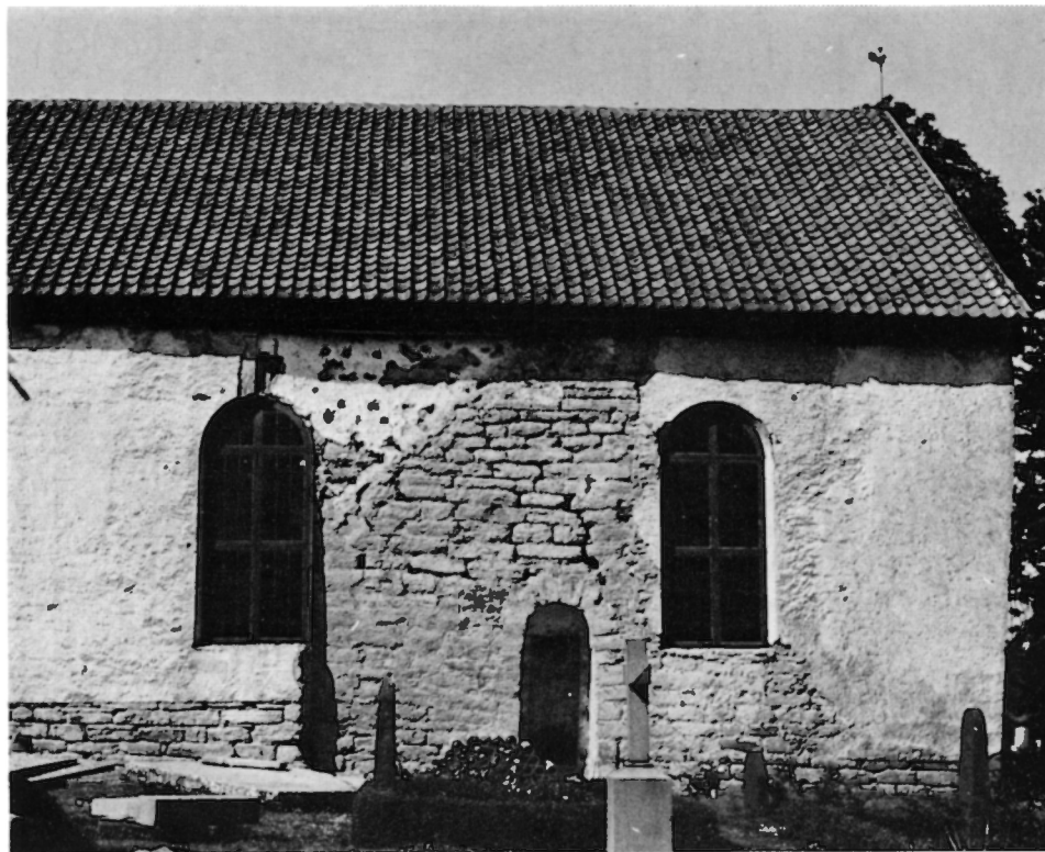
Fig 142. Spår av sakristia 2 i östtornets sydfasad, riven 1855. Jfr fig 13 ff, 141, 187, 189. Foto R Boström 1969.
