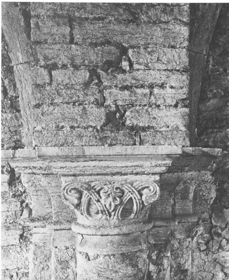
Fig 83. Kapitålet på väggpilastern A4. Observera skadorna på pilasterskaftet och jämför med kapitälets goda kondition. Foto A Edle 1913.
