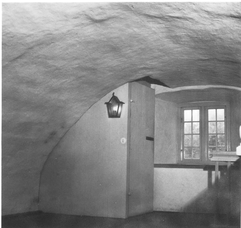
Fig 67. En del av vapenhusets tunnvalv mot sydväst. I en utspard öppning i valvet (delvis synlig på bilden) är ett trapphus från 1958 inbyggt. Foto R Boström 1963.
