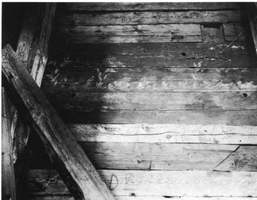
Fig 29. Håcksvik kyrka, vägg med infogade äldre väggplankor. Foto i ATA.
