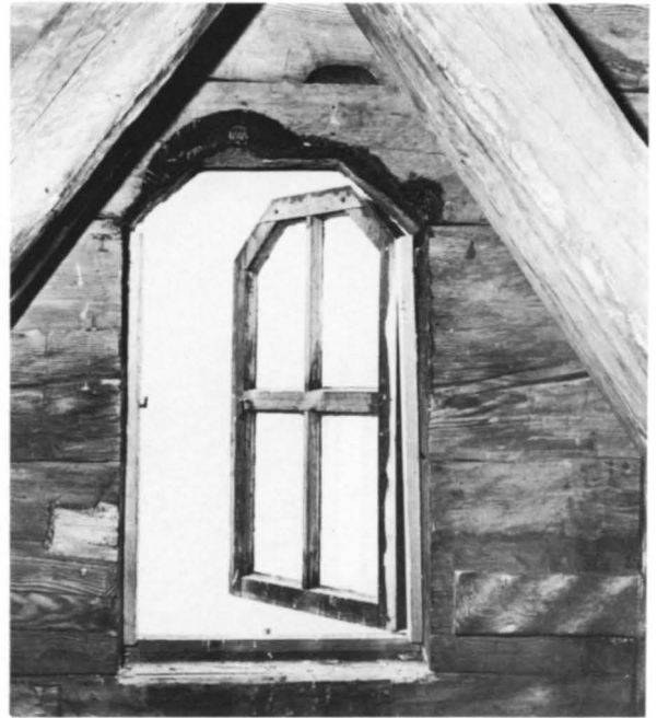
Fig 102. Älgårås. Fönster i långhusets västra gavelröste; märk spåren efter äldre fönsteromfattningar. Foto L Hasselberg 1979.
