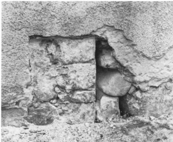
Fig. 64. Frilagd del av västra smygen till tornets södra ingång. Foto K Andersson 1971.
