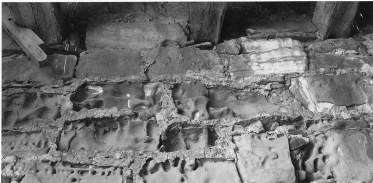
Fig 30. Vägparti med vittrad sandsten på insidan av tornets södra vägg. Foto 1988.
