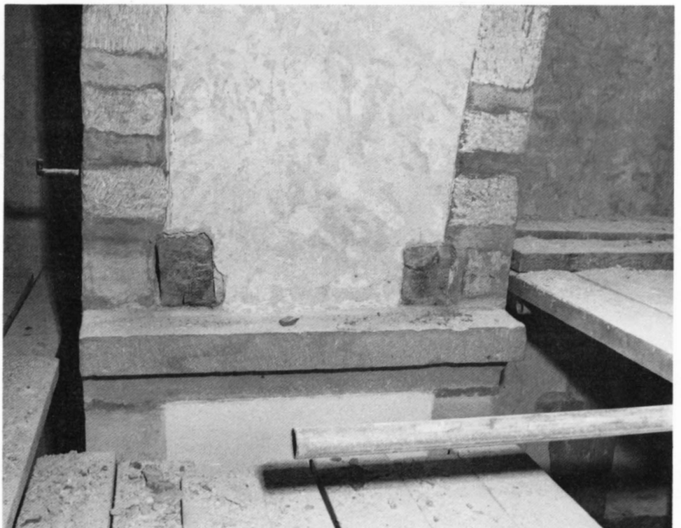
Fig 41. Avsågade stockändar i triumfbågen, möjligen rester av ett lektorium. Foto E Olsson 1971. GF.
