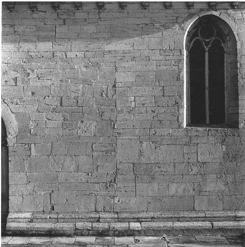
Fig. 48. Långhusets södra fasad, östra delen med det gotiska fönstret. Märk även murskarven strax väster om fönstret. Foto 1994.
